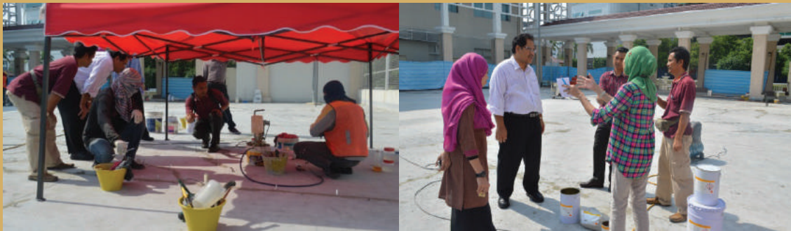
Pembaikan Keretakan Lantai Gelanggang Serbaguna Wisma Audit Negeri Selangor
