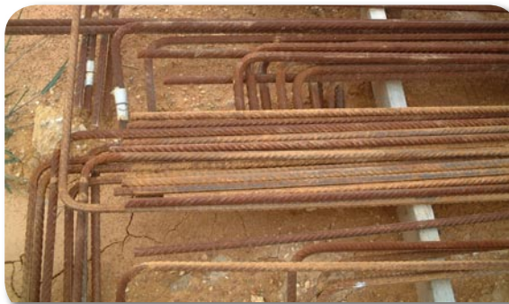
Bahan binaan (besi) terdedah kepada hujan dan panas mengakibatkan berkarat.
