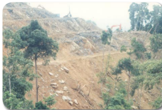
Pembinaan Jalan Di Kawasan Berbukit - Kerja memotong dan menambun tanah tidak mengikut spesifikasi.
