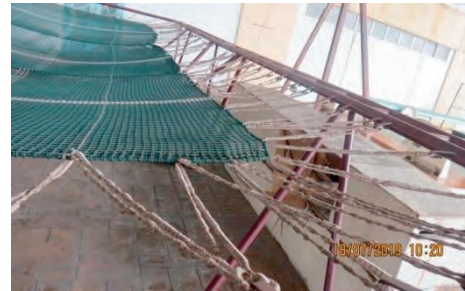
Pusat Akuatik Negeri Sembilan, Seremban - Keadaan Tali Trampoline Yang Telah Rosak (18.07.2019) (Sumber: Jabatan Audit Negara)
