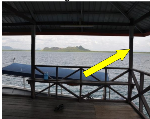
Gambar 2.4 Panjang Tiang Bumbung 4" x 4" Kurang 42.60 Meter
