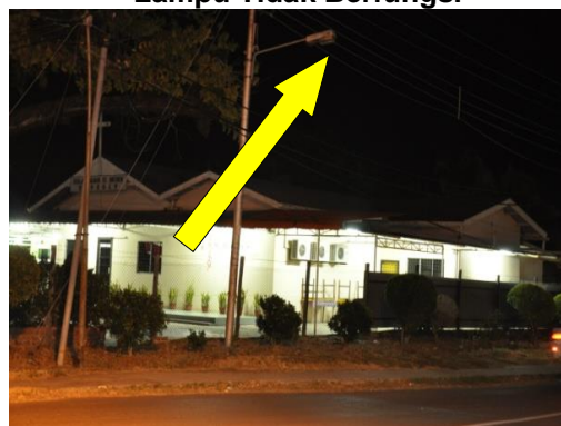
Gambar 2.23 Lampu Tidak Berfungsi
