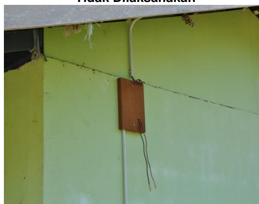
Gambar 2.18 Meter Dan Sambungan Bekalan Elektrik Tidak Dilaksanakan
