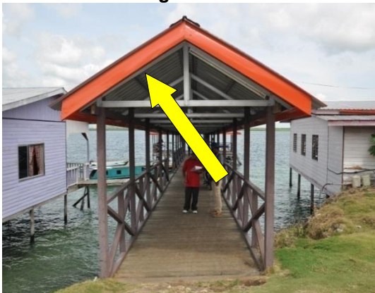
Gambar 2.5 Panjang Purlin Atap Kurang 49.35 Meter
