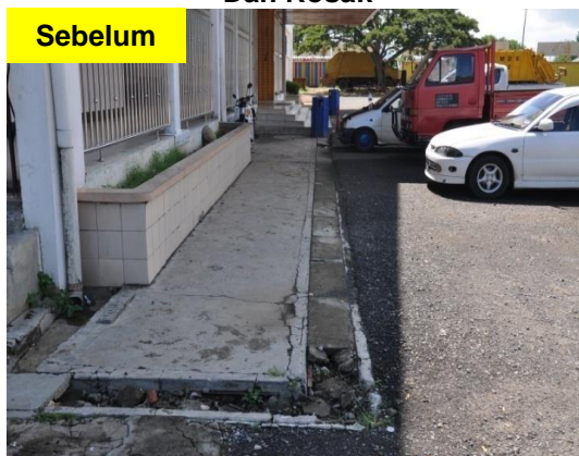
Gambar 2.15 Pemasangan Penutup Parit Kurang Dan Rosak
