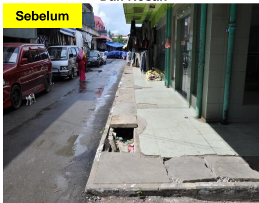
Gambar 2.13 Pemasangan Penutup Parit Kurang Dan Rosak
