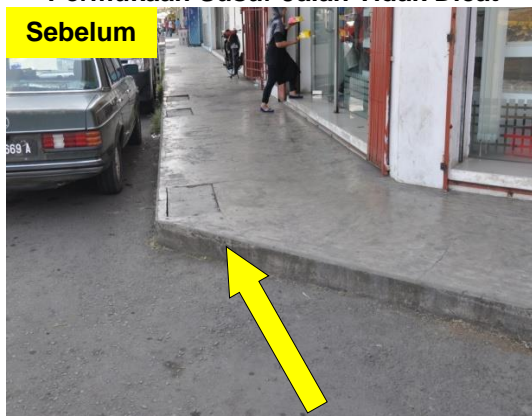
Gambar 2.7 Permukaan Susur Jalan Tidak Dicat
