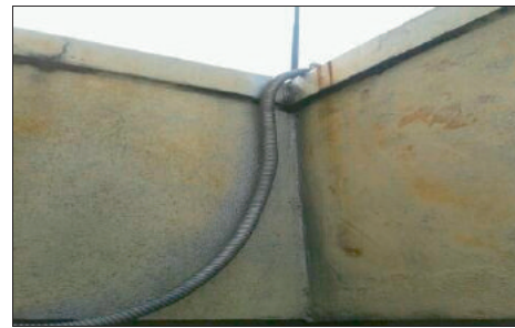
Aras Bumbung - Tindakan Telah Diambil (Sumber : BPH - 02.09.2013)
