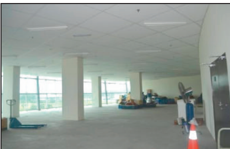
Bangunan Markas SMART (Fasa 2) - Stor 1 Di Aras 2 Yang Tidak Mempunyai Pengudaraan Menyebabkan Ianya Panas Dan Berbau (27.03.2013)
