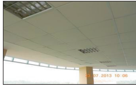
Bangunan Markas SMART (Fasa 2) - Siling Di Ruang Legar Aras 3 Telah Dibaiki Setelah Teguran Audit (Sumber: Majlis Keselamatan Negara - 10.06.2013)
