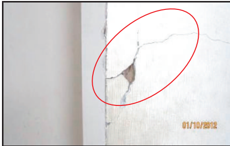
SK Sampadi, Lundu - Keretakan Pada Dinding Bangunan Sekolah Di Bilik Penolong Kanan (01.10.2012)
