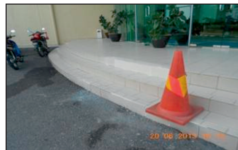
Bangunan Markas SMART (Fasa 2) - Jubin Di Anjung Telah Dibaiki Setelah Teguran Audit (Sumber: Majlis Keselamatan Negara - 20.06.2013)
