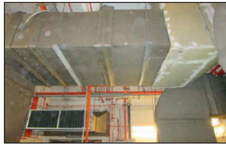
Bilik AHU Berdekatan Tangga Kecemasan No. 22, Aras 2 - Tindakan Telah Diambil (Sumber : BPH - 02.09.2013 )
