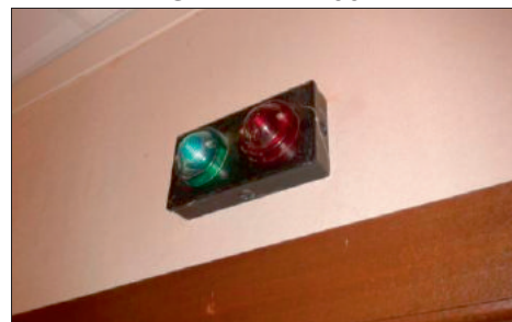
Bilik Kawalan, Aras Tanah - Tindakan Telah Diambil (Sumber : BPH - 02.09.2013)
