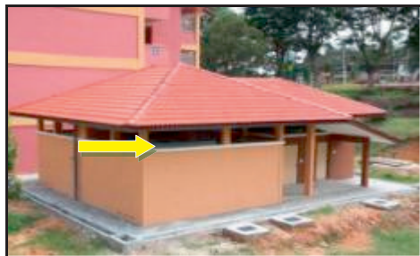
Tandas SK Tampin, Negeri Sembilan - Reka Bentuk Bangunan Tandas Mempunyai Ruang Terbuka Antara Beam Dan Siling (20.11.2012)
