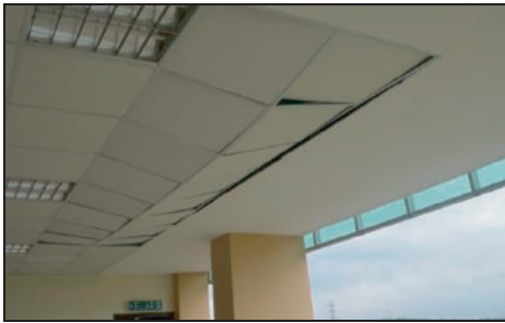
Bangunan Markas SMART (Fasa 2) - Siling Di Ruang Legar Aras 3 Hampir Runtuh (27.03.2013)
