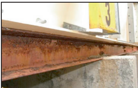
Aras Bumbung - Penyokong Besi Tangki Air Berkarat (21.01.2013)
