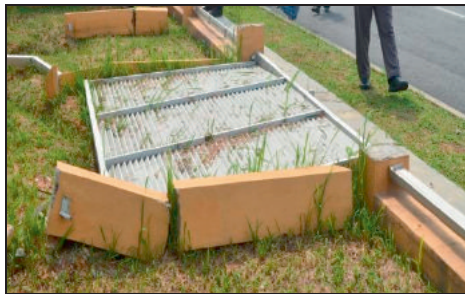
Rumah Pam (Fasa I) - Tiang Pagar Aluminium Ram Tumbang Kerana Tidak Mengandungi Besi Tetulang (25.03.2013)
