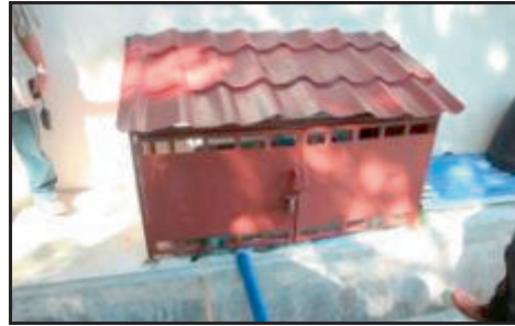
Tandas SMK Lajau, W.P. Labuan - Rumah Yang Menempatkan Booster Pump Bagi Menyedut Dan Membekalkan Air Ke Tandas Bila Tekanan Air Rendah (18.12.2012)
