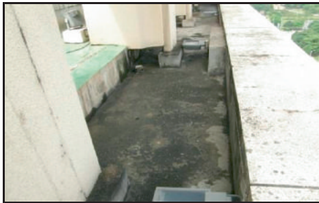
Bumbung Rata, Aras 6 - Gutter Konkrit Berlumut (21.01.2013)
