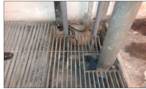
Basement 3 - Tindakan Telah Diambil (Sumber : BPH - 02.09.2013)
