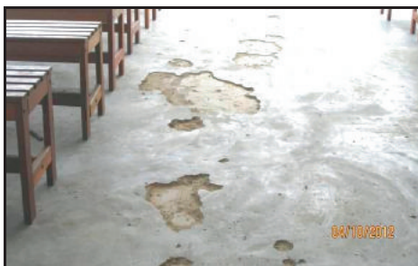
SK Nanga Ajau, Betong - Keadaan Lantai Simen Yang Berlubang Di Dewan Makan (04.10.2012)
