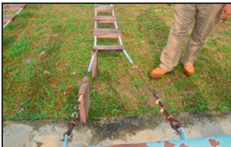
Litar Merempuh Halangan (Fasa 1) - Jacob Ladder Yang Tidak Disenggara (26.03.2013)
