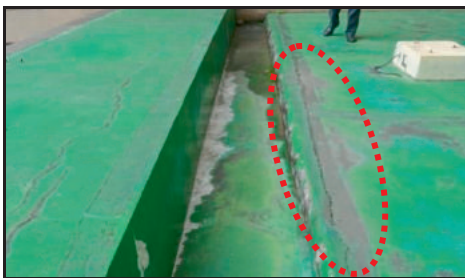
Bumbung Rata, Aras 6 - Retakan Di Antara Gutter Dan Lantai (21.01.2013)
