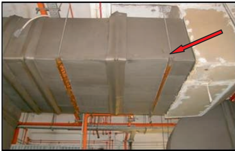
Bilik AHU Berdekatan Tangga Kecemasan No. 22, Aras 2 - Kesan Lelehan Air Pada Aircond Ducting Dan Bracket Telah Berkarat (16.01.2013)
