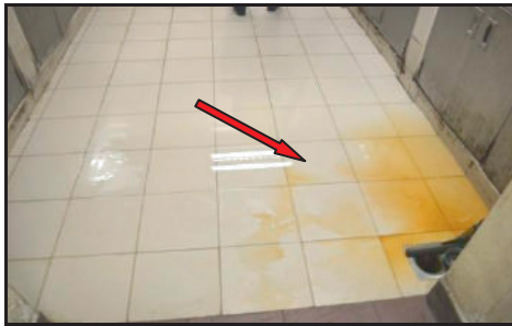
Kafeteria, Aras 2 - Air Bertakung Di Lantai Dapur (16.01.2013)
