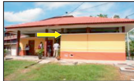
Tandas SK Sena, Perlis - Reka Bentuk Bangunan Tandas Mempunyai Ruang Terbuka Antara Beam Dan Siling (30.11.2012)
