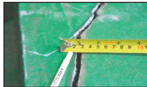
Bumbung Rata, Aras 6 - Lebar Keretakan Adalah 8 mm (21.01.2013)
