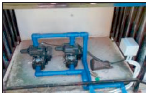
Tandas SMK Labuan, W.P. Labuan - Booster Pump (19.12.2012)
