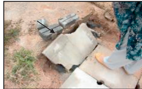
Padang SMK Dato' Undang Musa Al-Haj, Negeri Sembilan - Sambungan Longkang Untuk Mengalir Keluar Air Belum Disiapkan (10.12.2012)
