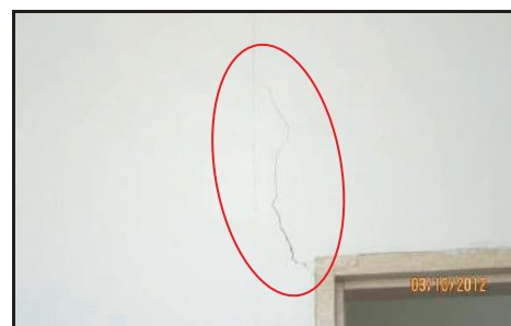
SK Lela Pahlawan, Sri Aman - Keretakan Pada Dinding Bangunan Sekolah Di Pejabat Pentadbiran (03.10.2012)
