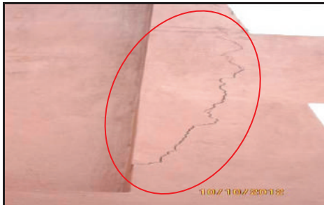
SMK Sebauh, Bintulu - Keretakan Pada Dinding Bangunan Sekolah Di Blok Pentadbiran (10.10.2012)
