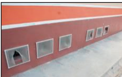
Tandas SK Kampong Serdang, Perlis - Jaring Lubang Udara Didapati Telah Koyak Dan Rosak (27.11.2012)
