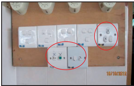
SMK Sebauh, Bintulu - Sistem Pendawaian Elektrik Tidak Sempurna Dan Banyak Suis Yang Tidak Berfungsi Di Dewan Makan (10.10.2012)
