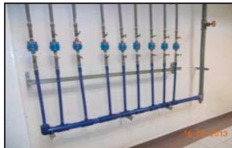
Kafeteria, Aras 2 - Tindakan Telah Diambil (Sumber : BPH - 26.08.2013)
