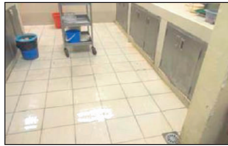
Kafeteria, Aras 2 - Tindakan Telah Diambil (Sumber : BPH - 26.08.2013)
