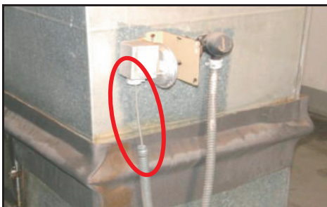
Bilik AHU 1, Aras Bumbung - Kabel Pada Paip Konduit 'Mudah Lentur' Terdedah (21.01.2013)
