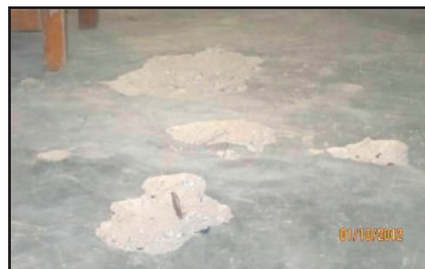
SK Sampadi, Lundu - Keadaan Lantai Simen Yang Berlubang Di Bilik Darjah (01.10.2012)
