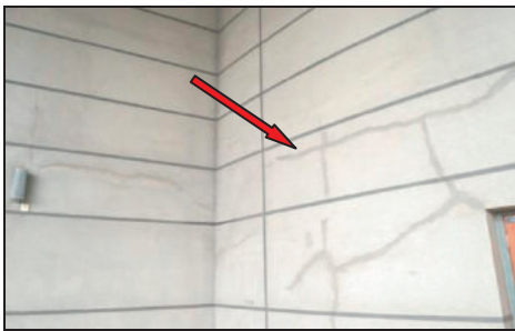
Perhentian Bas - Zon Kempas, Aras 2 (Outbound) - Keretakan Yang Dibaiki Kurang Memuaskan (16.01.2013)
