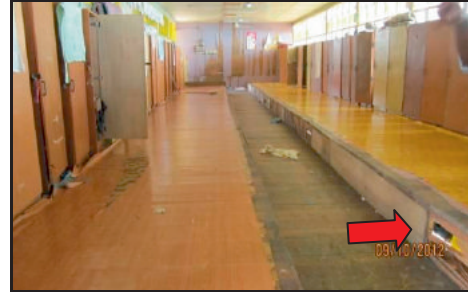
SK Nanga Merit, Kapit - Keadaan Di Dalam Bangunan Asrama Lama Yang Daif Dan Uzur (09.10.2012)
