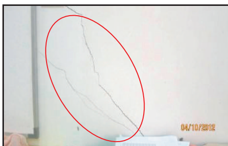
SK Nanga Ajau, Betong - Keretakan Pada Dinding Bangunan Sekolah Di Bilik Setiausaha Peperiksaan (04.10.2012)
