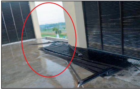
Bangunan Markas SMART (Fasa 2) - Aluminium Ram Di Menara Penyejuk Roboh (26.03.2013)
