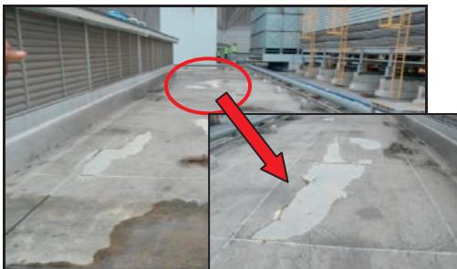
Aras Tangki Air, Bumbung Rata - Lapisan 'Waterproof' Rosak (16.01.2013)
