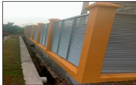
Rumah Pam (Fasa I) - Tiang Pagar Aluminium Ram Telah Dibaiki Setelah Teguran Audit (Sumber : Majlis Keselamatan Negara - 05.08.2013)
