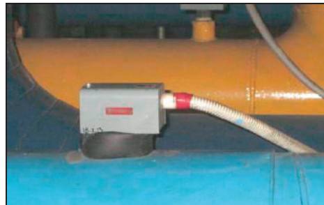
Chiller Plant Room - Tindakan Telah Diambil (Sumber : BPH - 26.08.2013)
