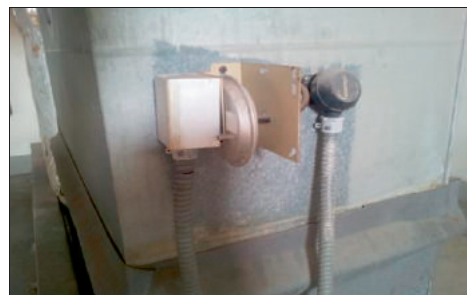
Bilik AHU 1, Aras Bumbung - Tindakan Telah Diambil (Sumber : BPH - 02.09.2013)
