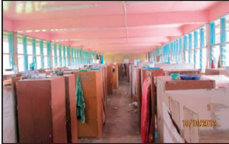
SMK Belaga, Kapit - Keadaan Di Dalam Bangunan Asrama Lama Yang Daif Dan Uzur (10.10.2012)
