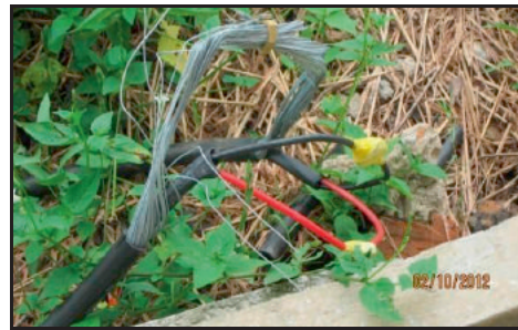
SK Pantu, Sri Aman - Wayar Elektrik Dibiarkan Terdedah Di Tepi Longkang Bangunan Asrama Perempuan (02.10.2012)
