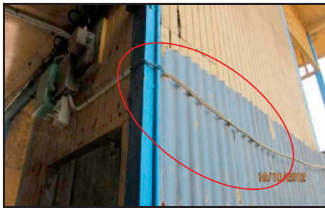
SMK Belaga, Kapit - Penyambungan Elektrik Secara Haram Dari Bangunan Asrama Lama Perempuan (10.10.2012)
