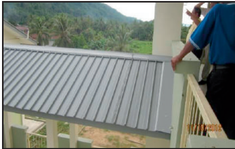
SK Sg. Poyan, Limbang - Jeriji Tidak Dipasang Bagi Mengelak Bumbung Bangunan Dicerobohi (11.10.2012)
