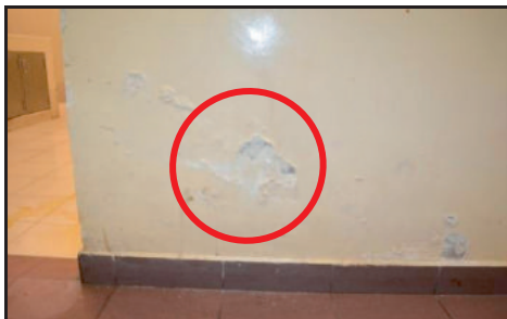
Kafeteria, Aras 2 - Cat Permukaan Dinding Menggelupas (16.01.2013)
