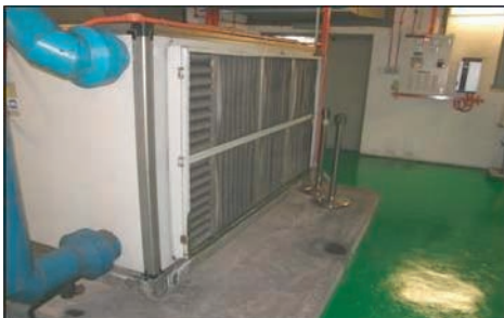
Bilik AHU Berdekatan Tangga Kecemasan No.22, Aras 2 - Penapis Udara Kotor Dan Berhabuk (16.01.2013)
