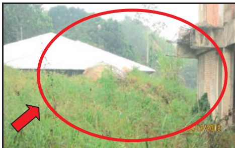
SK Long Sukang, Lawas - Tanah Runtuh Merosakkan Bangunan Sekolah Yang Dalam Proses Pembinaan (12.10.2012)
