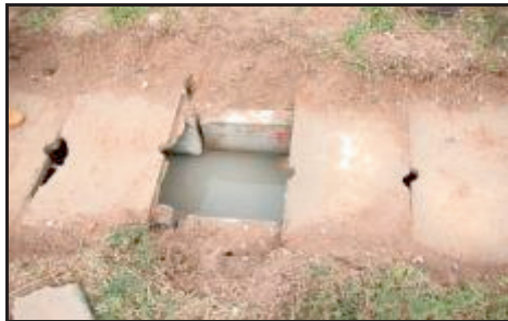
Padang SMK Dato' Undang Musa Al-Haj, Negeri Sembilan - Takungan Air Hujan Di Dalam Longkang Padang Dan Tidak Mengalir Ke Longkang Besar (10.12.2012)
