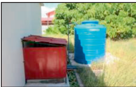
Tandas SMK Labuan, W.P. Labuan - Rumah Booster Pump Dan Tangki Air (19.12.2012)
