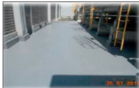
Aras Tangki Air, Bumbung Rata - Tindakan Telah Diambil (Sumber : BPH - 26.08.2013)
