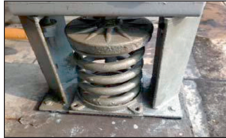
Aras Bumbung - Tindakan Telah Diambil (Sumber : BPH - 26.08.2013)
