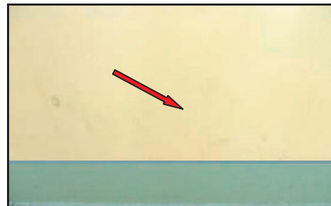
Kafeteria, Aras 2 - Tindakan Telah Diambil (Sumber : BPH - 26.08.2013)
