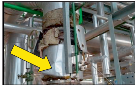
Salah Satu Syarikat Biodiesel Gebeng, Kuantan - Loji Biodiesel (Kerosakan Akibat Vandalisme) (20.12.2012)
