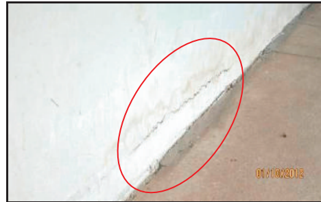
SK Tambirat, Samarahan - Keretakan Dan Kesan Resapan Air Pada Dinding Bangunan Sekolah Di Tandas Murid Lelaki (01.10.2012)
