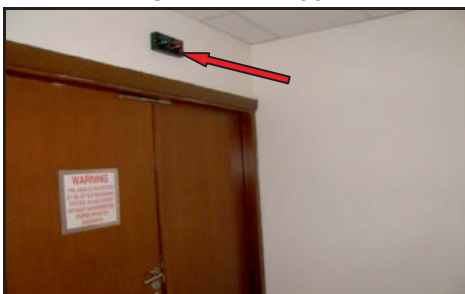
Bilik Kawalan, Aras Tanah - Lampu Amaran Tidak Menyala (21.01.2013)
