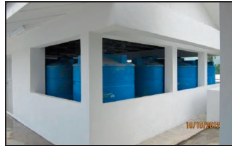
SMK Belaga, Kapit - Jeriji Tidak Dipasang Bagi Mengelak Tangki Air Dicerobohi (10.10.2012)
