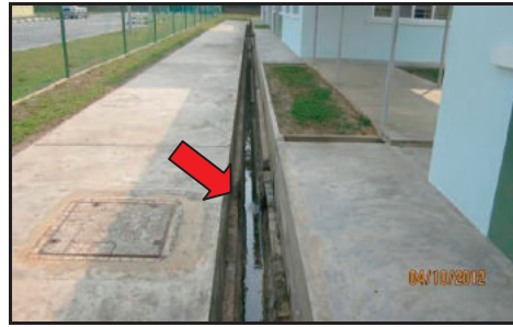
SK Nanga Ajau, Betong - Longkang Tidak Dilengkapkan Dengan Penutup Di Kawasan Asrama Pelajar (04.10.2012)
