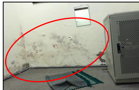
Bilik Server Kedutaan Besar Malaysia Di Hanoi, Vietnam - Kesan Resapan Air Pada Dinding (16.09.2015)
