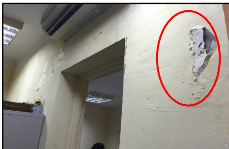
Bilik Pembantu Tadbir Kedutaan Besar Malaysia Di Hanoi, Vietnam - Cat Dinding Menggelupas (16.09.2015)
