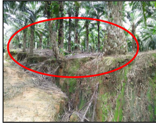
GAMBAR 8.20 Risiko Pokok Sawit Tumbang Jika Hakisan Tanah Pada Struktur Parit Dan Jalan Terus Berlaku
