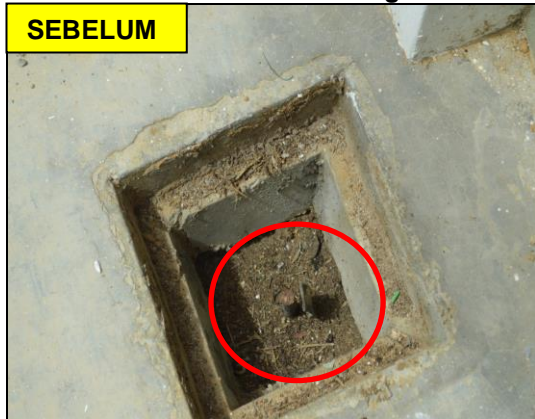
GAMBAR 6.1 Penyambungan Pada Earth Electrode Tidak Menggunakan Kaedah Exothermic Welding
