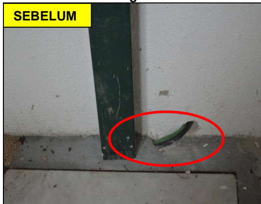
GAMBAR 6.3 Incoming Cable Tidak Menggunakan PVC Conduit Dan Risiko Kepada Kabel Yang Terdedah
