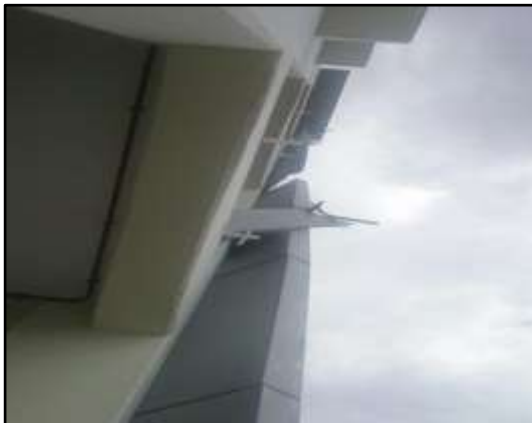
GAMBAR 2.44 Metal Cladding Tercabut (Pandangan Dari Luar Bangunan)
