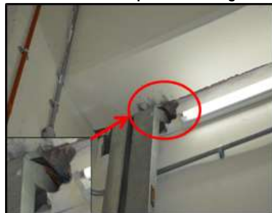
GAMBAR 2.40 Kabel Berada Di Luar Trunking Dan Tersepit Antara Penutup Dan Trunking
