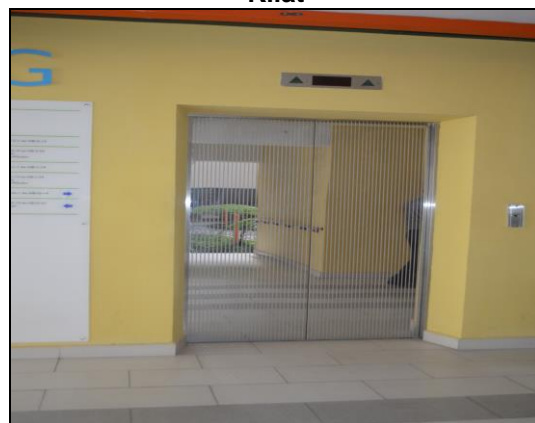
GAMBAR 6.20 Lif Di Asrama Yang Rosak Akibat Dipanah Kilat
