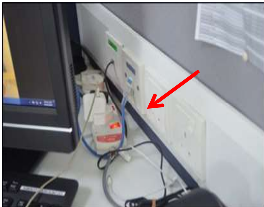
GAMBAR 2.31 Tiada Power Supply Bagi Plug Point Yang Dipasang
