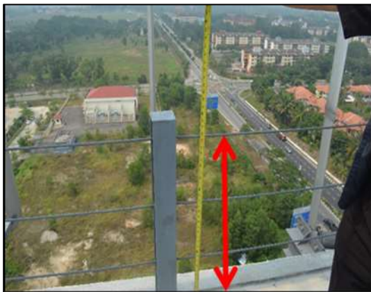
GAMBAR 2.29 Ketinggian Railing Kurang Daripada 1.5 Meter
