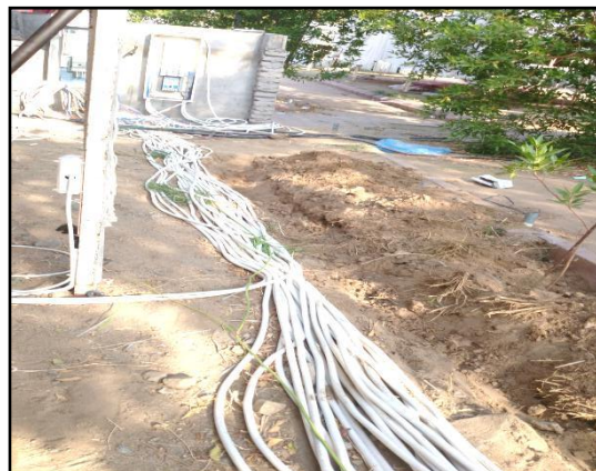
GAMBAR 9.5 Pemasangan Kabel Elektrik Belum Disiapkan
