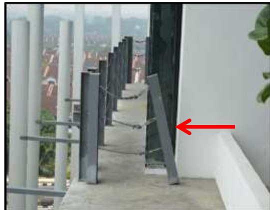
GAMBAR 2.30 Railing Tidak Dikimpal Pada Dinding
