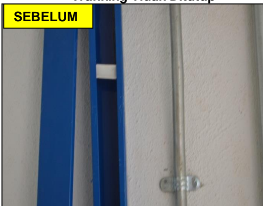
GAMBAR 6.5 Trunking Tidak Ditungkup
