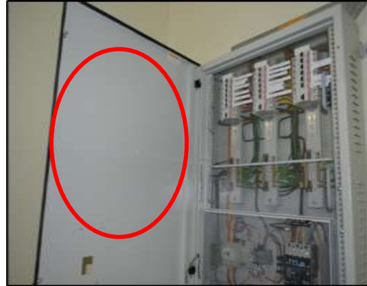
GAMBAR 2.22 Litar Skematik Tidak Diletakkan Dalam Pintu Distribution Board
