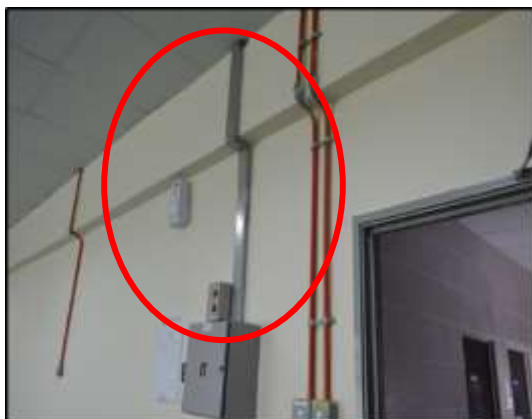
GAMBAR 2.19 Trunking Tidak Disokong Oleh Fixing Bracket
