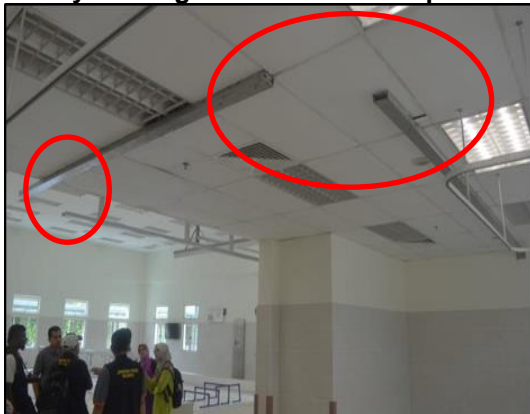
GAMBAR 6.11 Penyambungan Rail Tidak Disediakan
