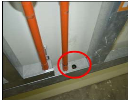
GAMBAR 2.36 Lubang Di Trunking Tidak Ditutup Setelah Ditebuk
