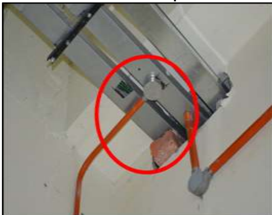
GAMBAR 2.37 Lubang Dan Laluan Trunking Tidak Ditutup
