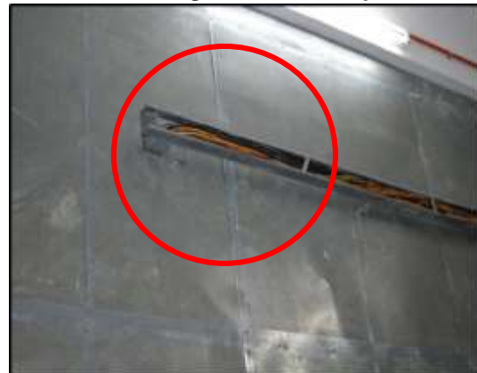
GAMBAR 2.18 Trunking Tidak Bertutup
