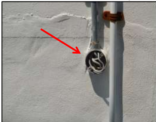
GAMBAR 2.17 Junction Box Tidak Bertutup
