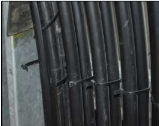
GAMBAR 2.23 Pengikat Kabel Tidak Menggunakan Pengikat Kabel Steel
