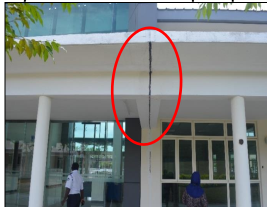
GAMBAR 6.12 Expansion Joint Tidak Ditutup Sempurna
