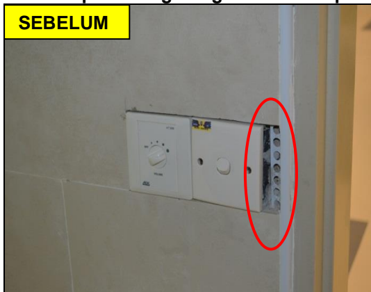
GAMBAR 6.9 Pemasangan Suis Tidak Kemas Kerana Terdapat Ruang Yang Tidak Ditutup
