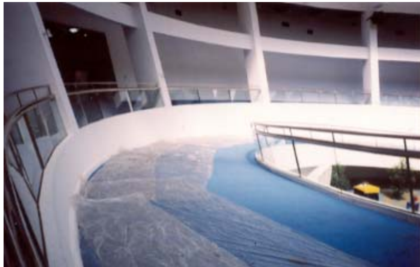
Lantai Yang Dialas Dengan Plastik Akibat Kebocoran Kubah
