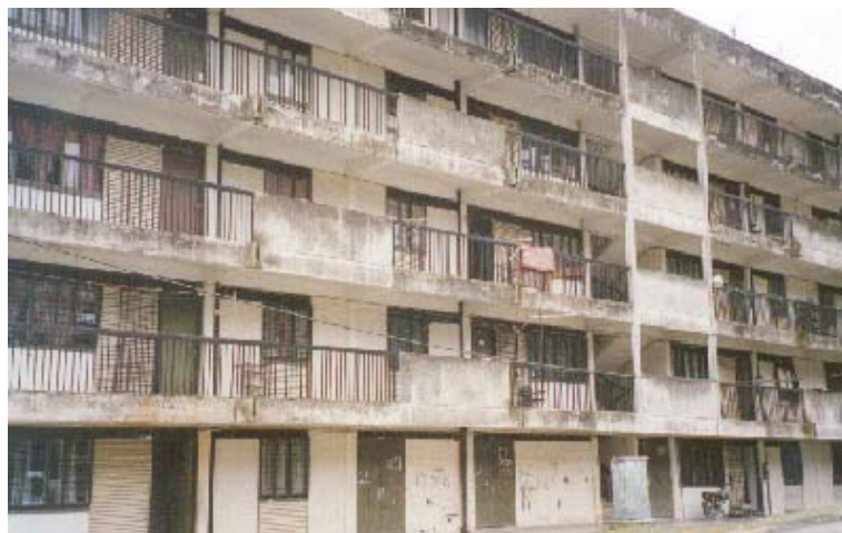
Kuarters Kelihatan Usang Kerana Tidak Pernah Dicat Sejak Diduduki
