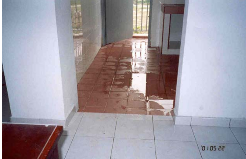
Lokasi : Rumah Anggota Hospital Tengku Ampuan Rahimah, Klang Yang Dibina Pada 22.2.1999 dan Disiapkan Pada 3.9.2000 Jenis Kecacatan : Air Meresap Keluar Dari Celahan Jubin Lantai
