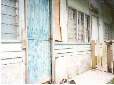
Rumah Diperbuat Daripada Kayu Yang Telah Usang Dan Terdapat Pelbagai Kerosakan
