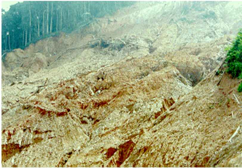
Keruntuhan Cerun Yang Serious Yang Mungkin Berpunca Daripada Mata Air
