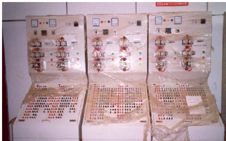
Peralatan Jentera Elektrik Tidak Digunakan Kerana Bengkel Elektrik Belum Siap Dibina Institut Wakaf Tapai, Terengganu
