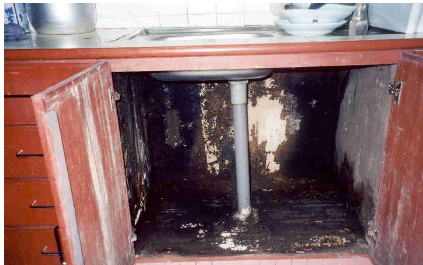
Lokasi : Rumah Anggota Klinik Kesihatan Air Puteh, Kuala Terengganu Yang Dibina pada 8.7.1998 Dan Siap Dibina pada 15.10.1999 Jenis Kecacatan : Kualiti Kayu Kabinet Dapur Yang Rendah
