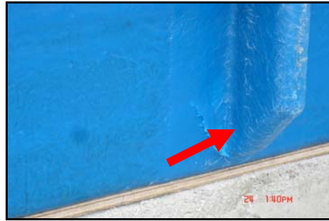
Projek Ternakan Udang Galah Kampung Luar, Baling, Kedah - Tangki Fiber Yang Mengalami Keretakan
