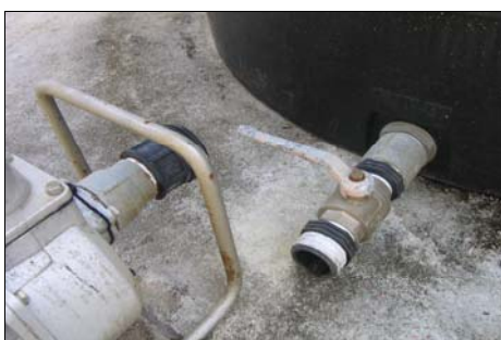
Tangki Utama Yang Tidak Disambung Ke Pam Sistem
