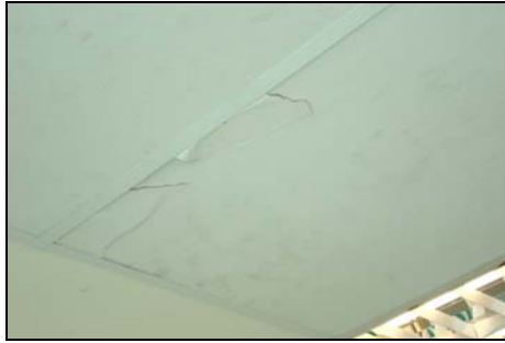
Kepingan Siling Yang Terkopak Di Beberapa Bahagian Di Ruang Pejabat Kompleks CIQ Masih Belum Diganti
