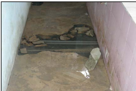
Kem Peladang Setiu Agro Resort, Terengganu - Lantai Rosak Tidak Dibaiki
