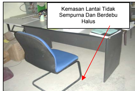
Kem Wawasan, Sabah - Kemasan Lantai Yang Tidak Sempurna
