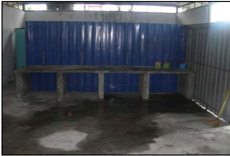
Kem Beringin Beach Resort, Langkawi - Lantai Tidak Rata Menyebabkan Air Bertakung Di Bilik Mandi Pelatih Wanita
