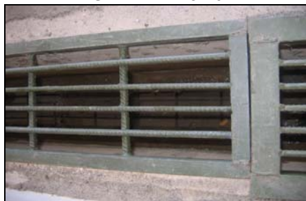
Penutup Longkang Tidak Sama Saiz
