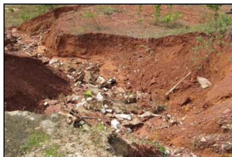
Runtuhan Cerun Dan Kerosakan Longkang
