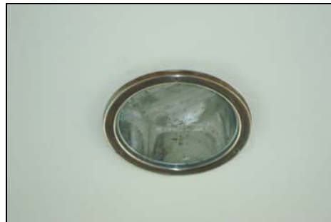
Ruang Utama Kompleks CIQ - Bingkai Lampu Yang Dipasang Telah Berkarat
