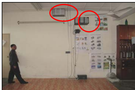
SK Dato' Traoh, Kota Samarahan, Sarawak Lokasi : Makmal Sains - Pembesar Suara Dan Komponennya (Fasa IV Dan V) Dipasang Dalam Satu Lokasi Yang Sama
