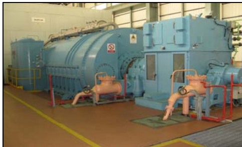
Stesen Jana Kuasa TNB Janamanjung Sdn. Bhd. - Generator Yang Sedang Beroperasi
