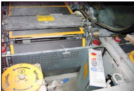
Sebahagian Komponen Mekanikal Eskalator Yang Dicuri - 25 April 2007
