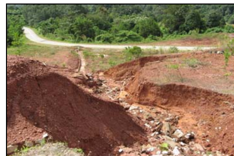
Runtuhan Cerun Dan Kerosakan Longkang
