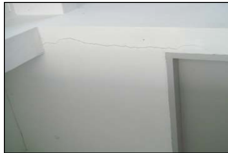
Pusat Sumber Felda Kota Gelanggi 2, Jerantut, Pahang - Keretakan Pada Dinding
