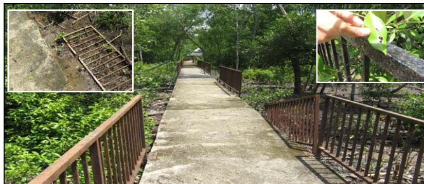
Laluan Siar Kaki Di Taman Alam, Kuala Selangor - Keadaan Railing Besi Laluan Siar Kaki Telah Berkarat/Rosak/Roboh
