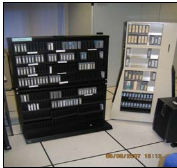
Backup Tape Disusun Dalam Rak
