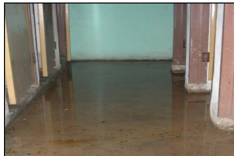
Kem Peladang Setiu Agro Resort, Terengganu - Lantai Yang Tidak Sempurna Menyebabkan Air Bertakung
