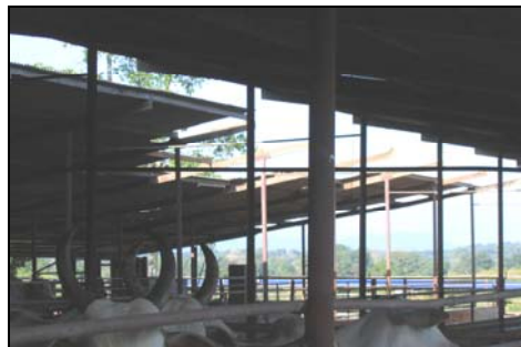
Bumbung Kandang Yang Rosak Tidak Dibaiki
