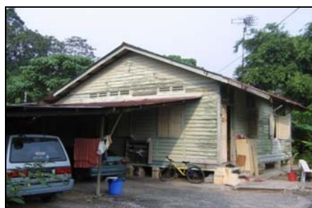
Bekas Rumah Pegawai Polis, Kampung Baru, Bentong, Pahang [PWD 333, 334, Lot 1954 Fasal 166 (4)] - Tiada Papan Tanda, Tidak Berpagar. Bekas Kuarters Ini Masih Dihuni Oleh Anggota Polis Yang Telah Bersara Walaupun Notis Keluar Telah Diberikan.
