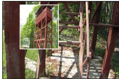
Menara Pandang Kayu di Taman Alam, Kuala Selangor - Menara Kayu Usang Dan Tangga Kayu Patah
