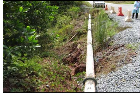
Pemendapan Dan Runtuhan Tanah Pada Jalan
