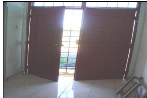
Pusat Sumber FELDA Chuping, Perlis - Simen Lantai Mengelembung Menyebabkan Pintu Keluar Dan Pintu Bilik Tidak Boleh Dibuka/Ditutup Dengan Mudah
