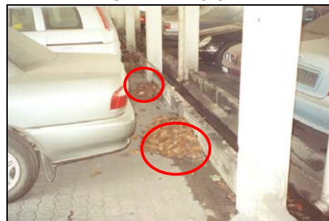
Stor Pencegahan Wisma Kastam Pelabuhan Utara, Selangor - Keadaan Stor Yang Tidak Bersih (Terdapat Longgokan Daun Kering)
