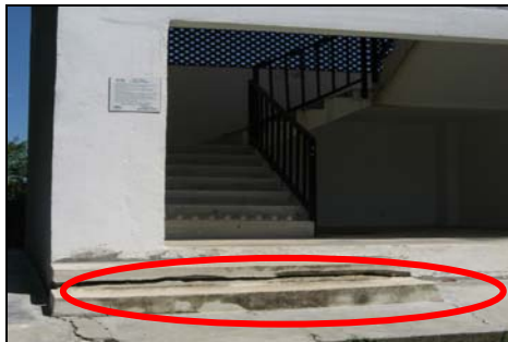
Menara Pandang Konkrit di Taman Alam, Kuala Selangor - Apron Di Kaki Menara Pandang Telah Retak
