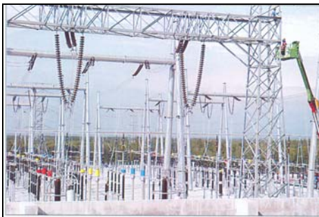
Stesen Jana Kuasa Jimah Energy Ventures Sdn. Bhd. - Kawasan Switchyard
