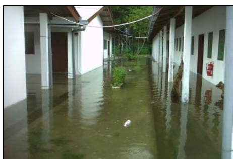
Kem Beringin Beach Resort, Langkawi - Persekitaran Bangunan Asrama Pelatih Dimasuki Air Laut Pasang Tinggi
