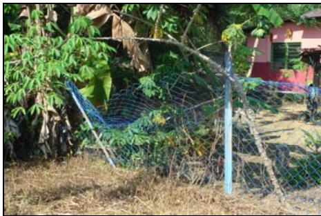
Pusat Sumber Padang Terap, Selama, Perak - Pagar Runtuh
