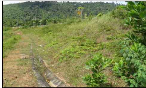
Longkang Yang Tersumbat Dan Rumput Yang Panjang Di Tepi Jambatan Utama
