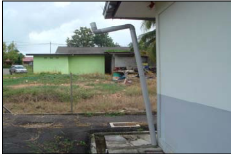
Pusat Sumber Kampung Binjal, Kayang, Kangar, Perlis - Saluran Paip Yang Telah Rosak
