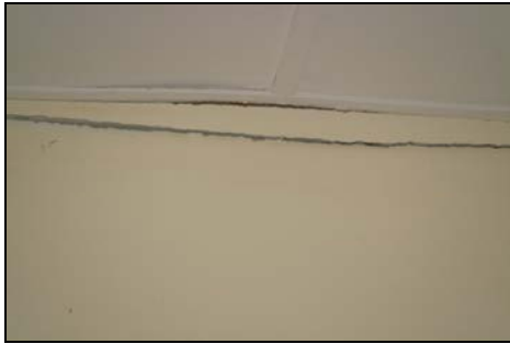
Pusat Sumber Batu 23, Selangor - Keretakan Yang Ketara Di Bilik Stor
