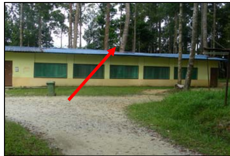
Kem Peladang Setiu Agro Resort, Terengganu - Bangunan Asrama Pelatih Yang Ditimpa Pokok Hutan Ditutupi Dengan Kanvas Sementara
