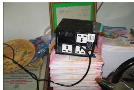
SMK Tun Telanai, Kuala Terengganu, Terengganu Lokasi : Makmal - AVR Yang Tercabut Akibat Vandalisme
