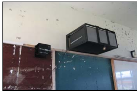
SMKA Sheikh Othman Abd Wahab, Kuching, Sarawak Lokasi : Bilik Darjah - AVR Fasa IV Didapati Hilang Kesan Dari Vandalisme
