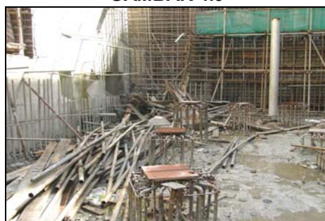
Tetulang Besi Di Powerhouse Tidak Disusun Dengan Kemas Dan Teratur
