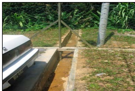
Kem Juara, Sarawak - Pagar Keselamatan Yang Tidak Ditanam Konkrit Kerb Dan Longkang Tidak Ditutup
