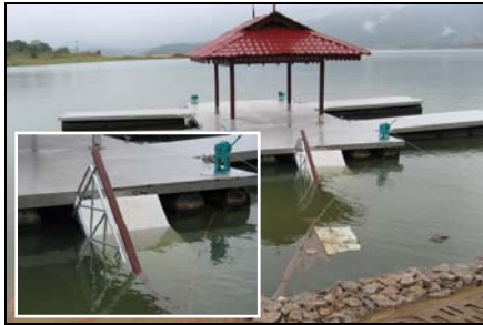
Jeti Pelampung Di Tasik Kenyir, Terengganu - Titi Yang Menghubungkan Jeti Dengan Daratan Telah Roboh Dan Tenggelam
