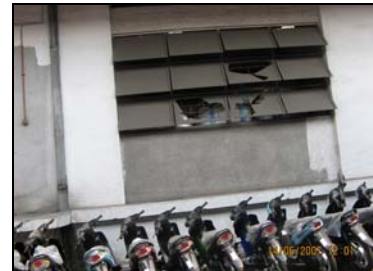
Keadaan Tingkap Gudang Yang Telah Pecah
