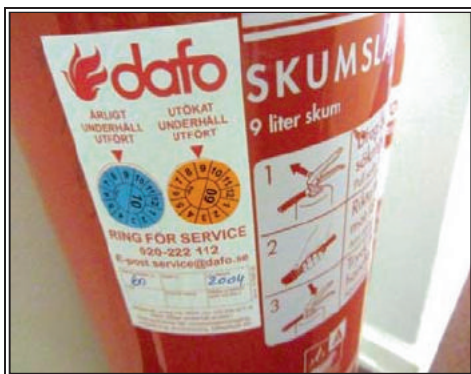
Kedutaan Besar Malaysia Di Stockholm, Sweden - Alat Pemadam Api Yang Telah Luput Tarikh Pada Bulan September 2010 (18.09.2012)
