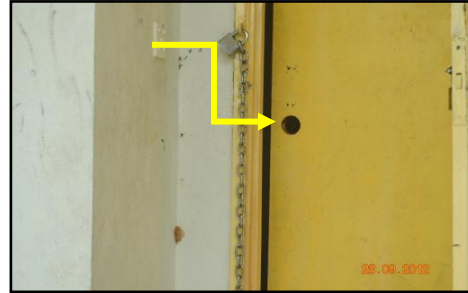
Taman Kejiranan Air Panas - Pintu Tandas Dirosakkan (28.09.2012)
