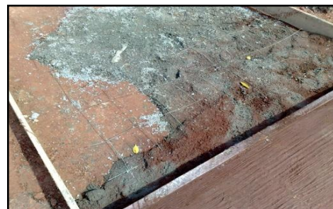
Taman Kejiranan Air Panas - Pembinaan Siar Kaki Tidak Mengikut Spesifikasi (06.09.2010) (Sumber: JLR)
