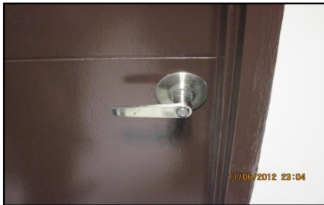
Bilik Server - Aras 1 - Tiada Ciri Keselamatan iaitu Pemasangan Key Bolt Door Pada Pintu Bilik Server (12.06.2012)
