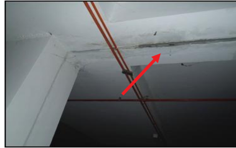
Tempat Meletak Kenderaan Bawah Tanah Basement 1 - Kesan Resapan Air Pada Expansion Joint (31.10.2012)
