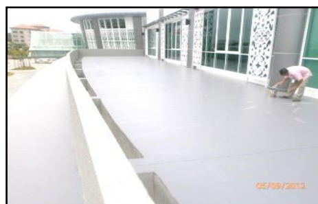
Aras Satu - Bumbung Rata - Keretakan Pada Lantai Bumbung Konkrit Rata Telah Diperbaiki Dengan Melapisi Permukaan Dengan 'Heating Resistant Waterproofing' (06.11.2012)
