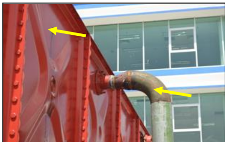
Bilik Tangki Bomba, Menara Satu - Pemasangan Overflow Pipe Masih Belum Siap Sepenuhnya Dan Tidak Dicat Dengan Warna Merah - Air Sentiasa Keluar Dari Warning Pipe Sepanjang Masa (27.11.2012)
