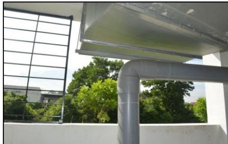
Tempat Meletak Kenderaan Bawah Tanah Basement 1 - Pemasangan Jeriji Besi Yang Tidak Sepenuhnya. Ruangan Terbuka Ini Membolehkan Orang Luar Masuk Ke Basement (27.11.2012)
