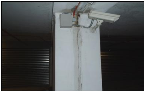
Tempat Meletak Kenderaan Bawah Tanah Basement 1 - Kesan Resapan Air Di Kamera Litar Tertutup (CCTV) (31.10.2012)
