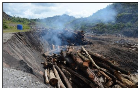
Kawasan Pelupusan Sisa Balak Dan Biomas - Trench Type Burner (07.11.2012)
