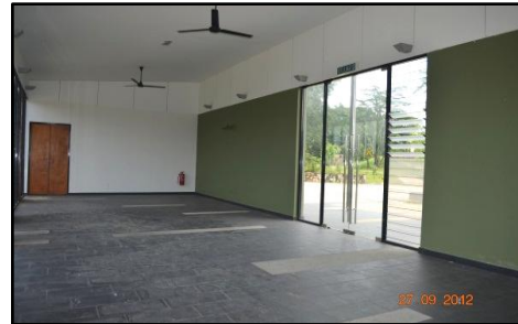
Taman Dusun Bandar - Bangunan Kafeteria/Bilik Pameran Yang Telah Siap Dibina Dibiarkan Kosong Dan Tidak Digunakan (27.09.2012)
