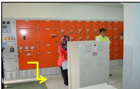
Bilik Substesen Selatan - Tiada Alas Getah Yang Diletakkan Di Hadapan Papan Suis (10.07.2012)
