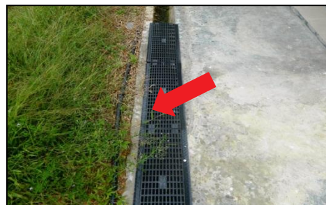
SK Ulu Ranan, Kanowit, Sarawak - Kontraktor Memasang Penutup Longkang Plastik Bukan Penutup Longkang Konkrit (06.09.2012)
