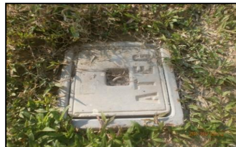
Luar Kompleks - Sistem Pembumian - Earth Chamber Telah Dipasang Sama Aras Dengan Permukaan Tanah (24.10.2012)
