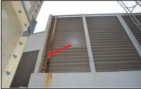
Aras Tangki Air & Chiller, Menara Satu - Kerangka Besi Louvres Berkarat (27.11.2012)
