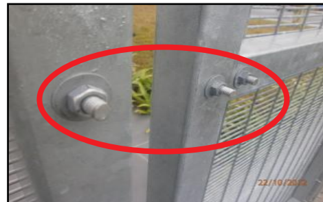
Jeti Ketibaan Dan Pelepasan - Bolt Yang Terkeluar Pada Pagar Keselamatan Telah Dipotong (06.11.2012)
