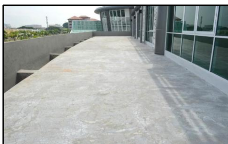
Aras Satu - Bumbung Rata - Keretakan Pada Lantai Bumbung Konkrit Rata (12.06.2012)
