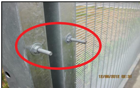
Jeti Ketibaan Dan Pelepasan - Bolt Yang Terkeluar Pada Pagar Keselamatan (12.06.2012)
