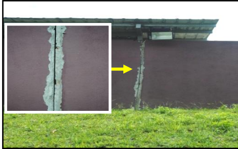
Taman Dusun Bandar - Dinding Bangunan Penyenggaraan Retak (27.09.2012)
