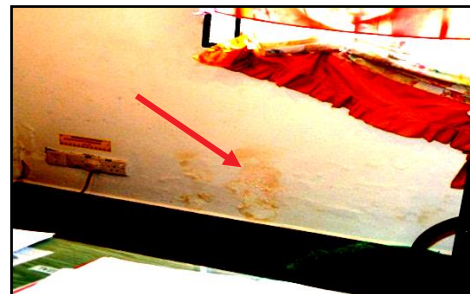
Taman Dusun Bandar - Kesan Resapan Air Di Dinding Pejabat (27.09.2012)
