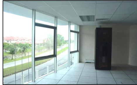
Bilik Server, Aras 1, Menara Satu - Reka Bentuk Dinding Jenis Cermin Tidak Sesuai Kerana Bilik Server Memerlukan Penghawa Dingin Beroperasi Selama 24 Jam. Perbezaan Suhu Di Antara Dalam Bilik Server Dan Bahagian Luar Cermin Akan Menyebabkan Pertumbuhan Kulat (27.11.2012)
