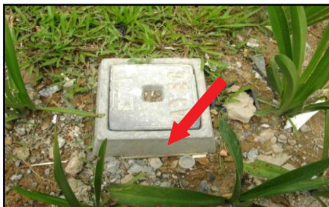
Luar Kompleks - Sistem Pembumian - Earth Chamber Yang Dipasang Lebih Tinggi Daripada Permukaan Tanah (12.06.2012)
