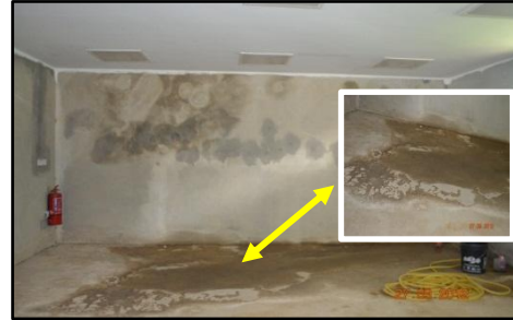
Taman Dusun Bandar - Kemasan Lantai Bersimen Dan Dinding Kawasan Dalam Bangunan Kafeteria Yang Tidak Sempurna (27.09.2012)
