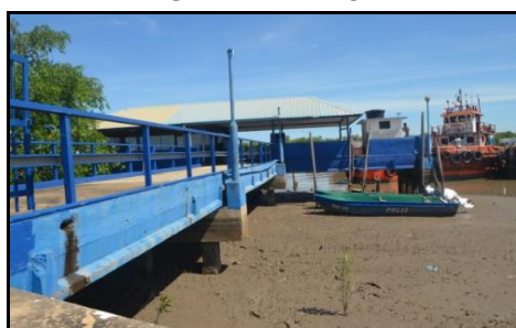
Jeti Kuala Kedah - Jeti Yang Tidak Sesuai Digunakan Kerana Air Cetek/Kering (10.07.2012)
