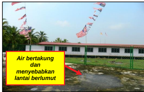
SK Kalok, Julau, Sarawak - Kerja Kemas Lantai Di Luar Bangunan Yang Kurang Kemas Menyebabkan Air Bertakung Dan Lantai Berlumut (05.09.2012)
