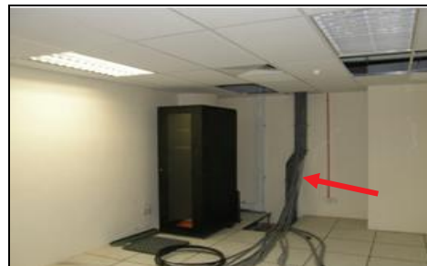
Bilik Server, Aras 1, Menara Satu - Pendawaian Elektrik Untuk Pusat Data Masih Belum Siap Sepenuhnya (27.11.2012)
