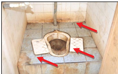
SMK Kabogan II, Semporna, Sabah - Lantai Dan Lubang Tandas Kotor (14.07.2012)
