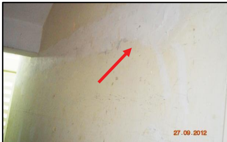
Taman Dusun Bandar - Kemasan Dinding Bilik Stor Tidak Sempurna (27.09.2012)
