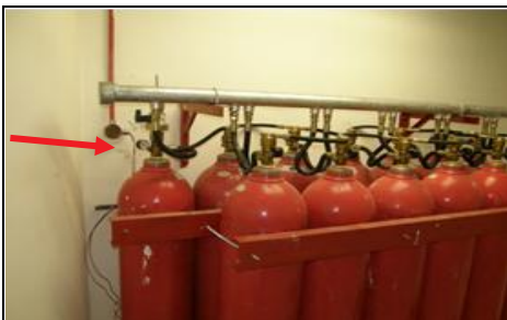
Bilik Server, Aras 1, Menara Satu - Sistem Pencegah Kebakaran CO2 Masih Tidak Disambungkan Dengan Sempurna Ke Pilot Cylinder (27.11.2012)
