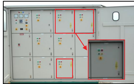
Kolam Takungan No. 3 - Panel Bertanda Menunjukkan Pam Yang Tidak Berfungsi (12.07.2012)
