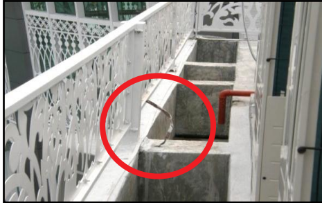
Atas Bumbung - Copper Tape Yang Tidak Disambung Sebagai Perlindungan Pembumian (12.06.2012)
