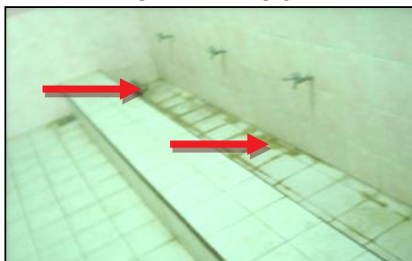
SMK Putra, Kangar, Perlis - Lantai Tempat Mengambil Wuduk Kotor (06.09.2012)
