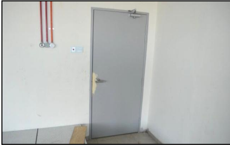
Bilik Server, Aras 1, Menara Satu - Reka Bentuk Pintu Satu Daun Tidak Sesuai Untuk Mengangkut Perkakasan ICT (27.11.2012)
