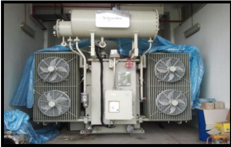
Alat Ubah 33/11kV (Power Transformer), DCP 1, Cyberjaya - Unit 1 Belum Boleh Digunakan (19.11.2012)
