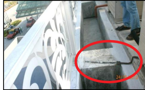
Atas Bumbung - Copper Tape Yang Telah Disambung Sebagai Perlindungan Pembumian (24.10.2012)
