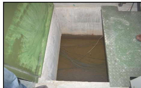
Bilik Substesen Selatan - Air Bertakung Di Dalam Parit Laluan Kabel (10.07.2012)
