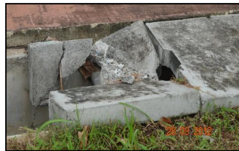
Taman Kejiranan Air Panas, Setapak - Penutup Longkang Rosak (28.09.2012)
