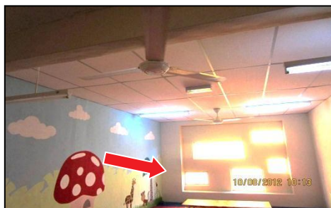
SK Cyberjaya, Sepang, Selangor - Jeriji Besi Tidak Dipasang Di Setiap Frame Tingkap Bagi Projek Prasekolah Fasa 1 (10.08.2012)
