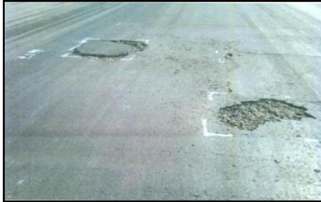
- Pothole Di Runway (Sumber: MASB) (27.06.2011)
