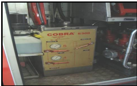
BBP Papar, Sabah - Peralatan Cobra Cutting Extinguisher E300 Yang Tidak Dapat Digunakan (25.09.2012)
