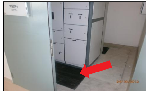
Atas Bawah - Bilik Suis (Riser 4) - Pelapik Getah Telah Diletakkan Di Hadapan Papan Suis (24.10.2012)
