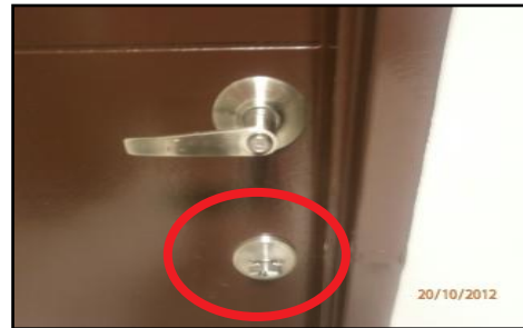
Bilik Server - Aras 1 - Ciri Keselamatan Pada Pintu Bilik Server Telah Disediakan Dengan Menambah Key Bolt Door (20.10.2012)
