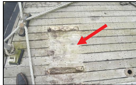
Jeti DMS Bakar Batu, Johor - Lantai Kayu Kapal PX 8 Telah Reput (18.07.2012)
