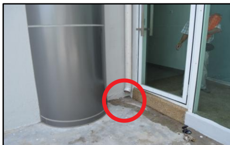
Aras Bumbung Rata - Kerja Pemasangan Saluran Paip Hujan Yang Tidak Sempurna (12.06.2012)
