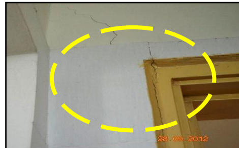
Taman Kejiranan Air Panas, Setapak - Keretakan Siling Dan Dinding Di Pejabat Pentadbiran (27.09.2012)
