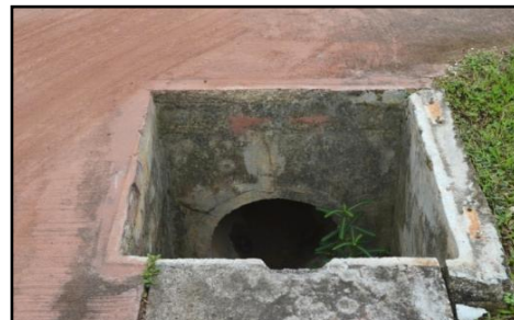
Taman Kejiranan Air Panas - Penutup Sump Telah Dicuri Dan Boleh Membahayakan Pengguna (28.09.2012)
