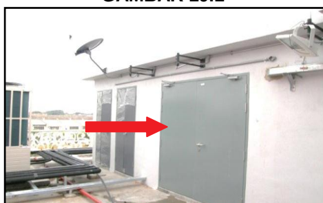
Aras 2 - Bilik Suis - Papan Tanda 'DILARANG MASUK', 'BAHAYA' Dan 'DILARANG MEROKOK' Tidak Dipasang (12.06.2012)
