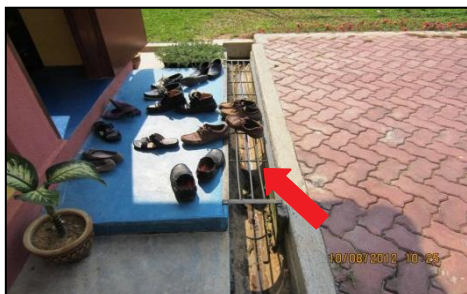
SK Cyberjaya, Sepang, Selangor - Kontraktor Memasang Penutup Longkang Besi Bukan Penutup Longkang Konkrit (10.08.2012)
