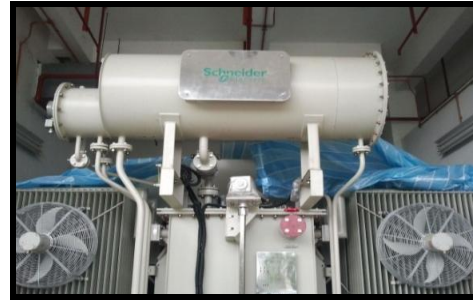
Alat Ubah 33/11kV (Power Transformer), DCP 1, Cyberjaya - Unit 2 Belum Boleh Digunakan (19.11.2012)
