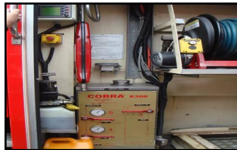
BBP Sipitang, Sabah - Peralatan Cobra Cutting Extinguisher E300 Yang Tidak Dapat Digunakan (25.09.2012)
