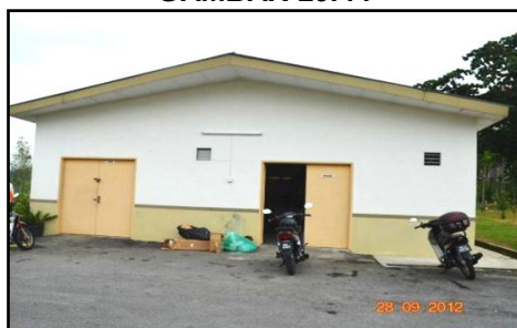
Taman Kejiranan Air Panas - Pintu Stor Tidak Dipasang Jeriji Besi (28.09.2012)
