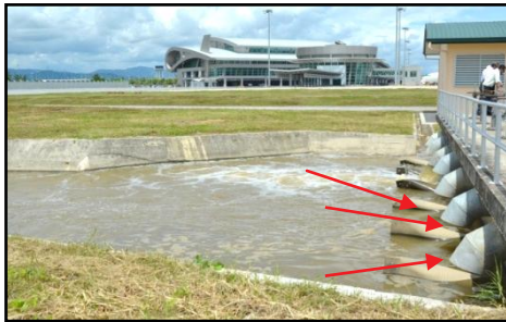
Kolam Takungan No. 3 - 3 Daripada 7 Pam Tidak Berfungsi (12.07.2012)
