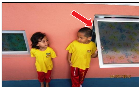
SK Seksyen 27(2), Shah Alam, Selangor - Tingkap Jenis Top Hung Tidak Sesuai Dan Dipasang Terlalu Rendah Yang Boleh Membahayakan Murid (04.07.2012)
