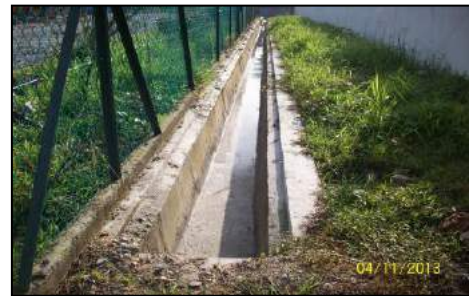
Longkang, Sewerage Treatment Plant - Longkang Telah Diratakan Dengan Lapisan Konkrit Bagi Mendapatkan Aliran Air Yang Betul (Sumber : JKR - 20.12.2013)
