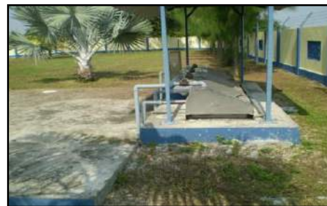
PMK Pengkalan Kubor, Kelantan - Tangki Minyak Bawah Tanah Yang Tidak Digunakan (24.06.2013)
