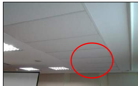
PMK Weld Quay, Pulau Pinang - Kerosakan Pada Siling Di Bilik Gerakan Telah Dibaiki Pada 27.09.2013 (Sumber: Unit Marin Weld Quay)
