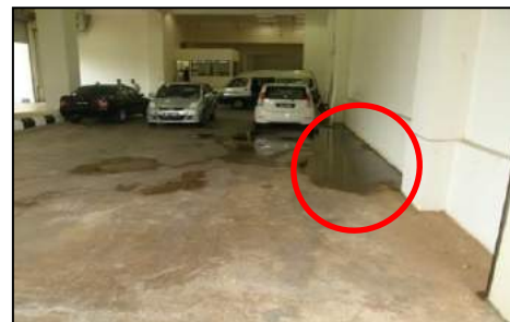
Sub-Besmen 5, Drop Of Point OKT - Air Bertakung Pada Permukaan Lantai Drop Of Point Kerana Jalan Luar Lebih Tinggi Dan Menggunakan Covered Drain (19.06.2013)
