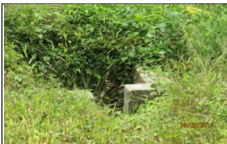
BR 15 Padang Sanai - Longkang Dan Sump Pit Tidak Disenggarakan Dengan Baik (18.06.2013)
