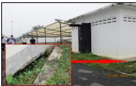
Sewerage Treatment Plant - Retakan Pada Struktur Loji Akibat Daripada Mendapan Tanah (25.06.2013)
