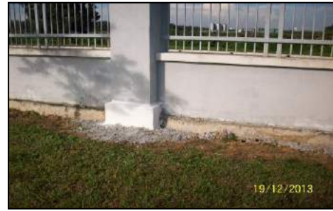
Pagar - Pagar Di Sekeliling Politeknik Telah Dibina Di Atas Cerucuk. Mendapan Tanah Di Kawasan Terlibat Telah Dibaiki (Sumber: JKR - 20.12.2013)
