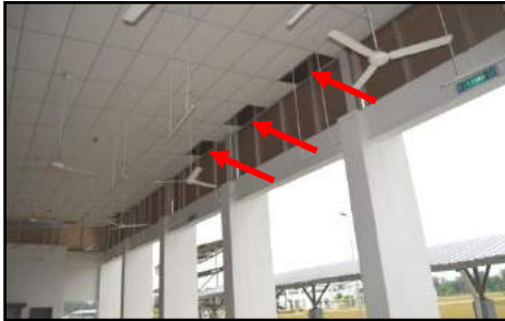
Kantin - Siling Bumbung Tertanggal (26.06.2013)
