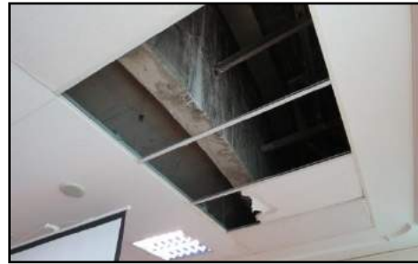
PMK Weld Quay, Pulau Pinang - Kerosakan Pada Siling Di Bilik Gerakan (27.08.2013)
