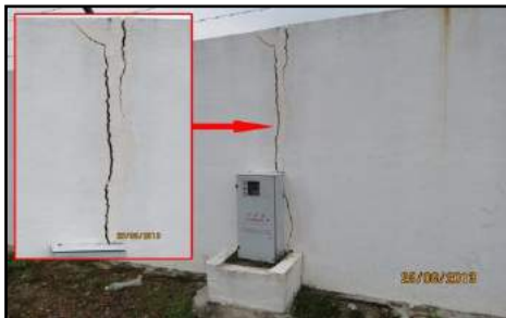
Sewerage Treatment Plant - Keretakan Pada Dinding Tembok Pagar (25.06.2013)
