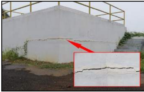
Sewerage Treatment Plant - Rekahan Pada Struktur Loji Akibat Daripada Mendapan Tanah (25.06.2013)
