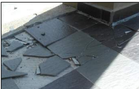
PMK Sungai Pulai, Johor - Lantai Di Bahagian Lobi Depan Bangunan Pentadbiran Pecah (08.10.2013)
