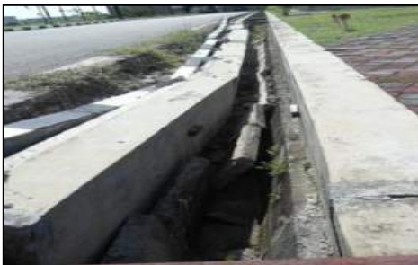
PMK Sungai Pulai, Johor - Tembok Longkang Tumbang Dan Pecah (08.10.2013)
