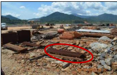
Empangan Paya Peda, Besut, Terengganu (Intake Tower) - Besi Binaan Berkarat (02.07.2013)
