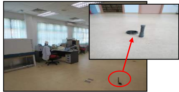
Makmal Patologi, HAT Wilayah Kota Kinabalu - Makmal Tidak Dibekalkan Dengan Meja Dan Singki Menyebabkan Saluran Singki Yang Telah Disediakan Terdedah Dan Boleh Membahayakan Pekerja Makmal (20.08.2013)
