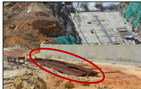
Empangan Paya Peda, Besut, Terengganu (Kawasan Berhampiran Service Spillway) - Besi Binaan Berkarat (02.07.2013)
