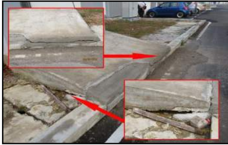
Kantin - Kesan Retakan Di Laluan Pejalan Kaki Di Kantin (25.06.2013)
