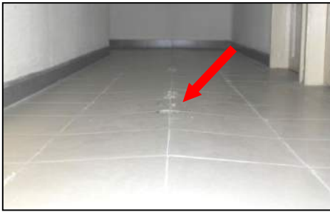
PMK Sungai Pulai, Johor - Jubin Lantai Bangunan Rosak/Menggelembung (09.10.2013)
