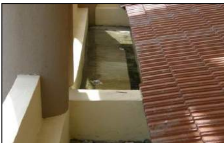
Tingkat Bawah, Laluan Ke Mahkamah Majistret 4 - Air Bertakung Pada Lantai Konkrit Gutter (19.06.2013)
