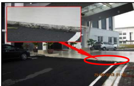
Lobi, Blok Pentadbiran - Jalan Mendap Akibat Daripada Mendapan Tanah (25.06.2013)
