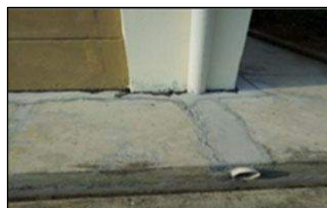
PMK Sungai Pulai, Johor - Keretakan Apron Yang Telah Dibaiki Dengan Sempurna (Sumber: JKR)
