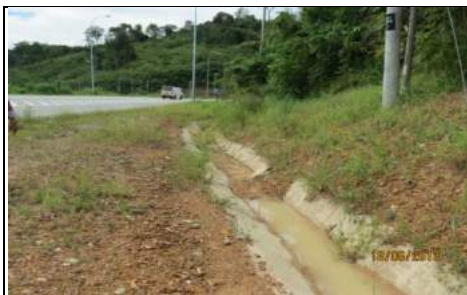
Jalan Berhadapan Tangki Air SADA, Padang Sanai - Longkang Tidak Disenggarakan Dengan Baik (18.06.2013)
