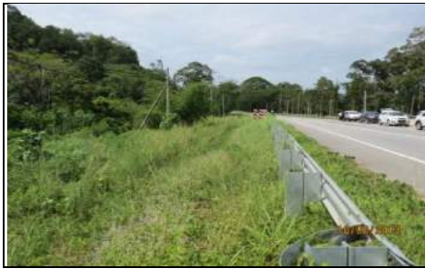
Jambatan BR1 Sungai Padang Terap (CH31534) - Rumput Tidak Dipotong (18.06.2013)
