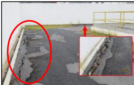
Sewerage Treatment Plant - Jalan Mendap Akibat Daripada Mendapan Tanah (25.06.2013)
