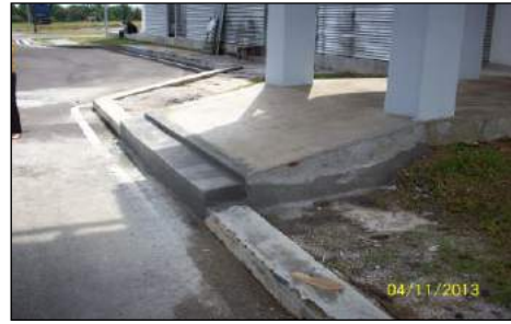
Kantin - Retakan Pejalan Kaki Telah Siap Dibaiki (Sumber: JKR - 20.12.2013)
