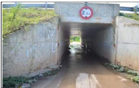
Terowong Kenderaan Ringan (Kawasan Vehicular Box Culvert) - Air Bertakung Di Atas Jalan (Resapan Air Ke Dalam Lapisan Jalan Yang Telah Retak Boleh Menyebabkan Kekuatan Jalan Merosot) (18.06.2013)
