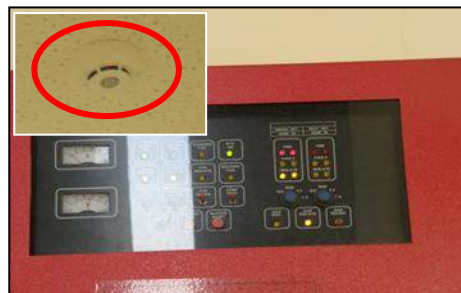
Aras 2, Bilik Fail Mahkamah Majistret - Sistem Pengesan Asap Di Dalam Bilik Fail Sentiasa Aktif Dan Lampu Penunjuk Kebakaran Pada Clean Agent Control Panel Sentiasa Menyala. (19.06.2013)
