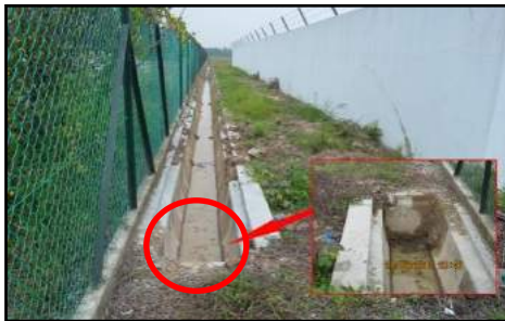
Longkang, Sewerage Treatment Plant - Mendapan Tanah Mengakibatkan Kecerunan Longkang Berubah Dan Air Longkang Tidak Dapat Mengalir (25.06.2013)
