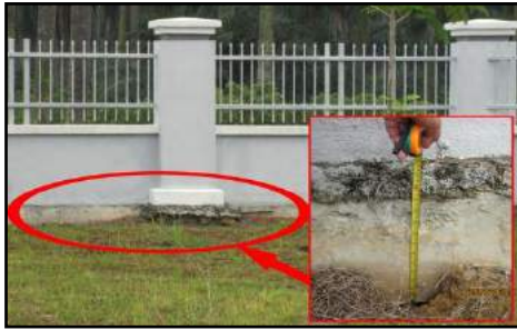
Pagar - Terdapat Kesan Mendapan Tanah Di Sepanjang Tembok Pagar (25.06.2013)
