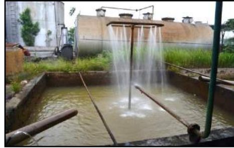
Syarikat Green Pluslink Sdn. Bhd., Pelabuhan Klang, Selangor - Sistem Penyejukan Yang Menggunakan Air Hujan (28.08.2013)
