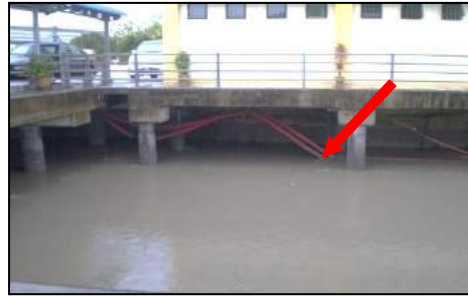
PMK Kuala Perlis, Perlis - Kabel Elektrik Terendam Semasa Air Pasang (12.06.2013)
