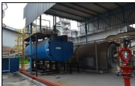
Syarikat Daya Clarimax Sdn. Bhd., Pelabuhan Klang, Selangor - Dandang Pemanasan Dan Thermal Oxidizer (Waste Heat Recovery Plant) (30.8.2013)
