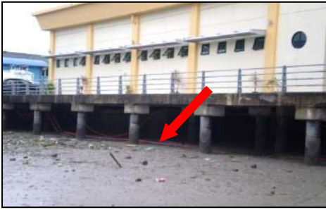
PMK Kuala Perlis, Perlis - Kabel Elektrik Terdampar Sewaktu Air Surut (12.06.2013)
