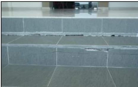
PMK Sungai Pulai, Johor - Tangga Bangunan Pejabat Depan Retak (08.10.2013)
