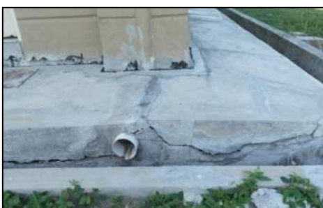
PMK Sungai Pulai, Johor - Keretakan Apron Yang Telah Dibaiki Tidak Sempurna (08.10.2013)
