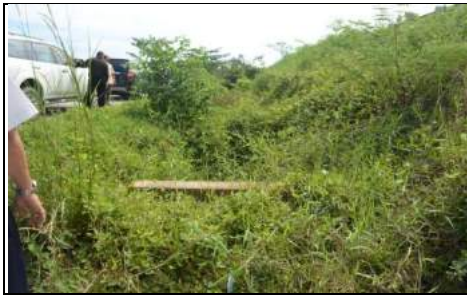
Terowong Kenderaan Ringan (Kawasan Vehicular Box Culvert) - Rumput Tidak Dipotong Dan Disenggarakan (18.06.2013)
