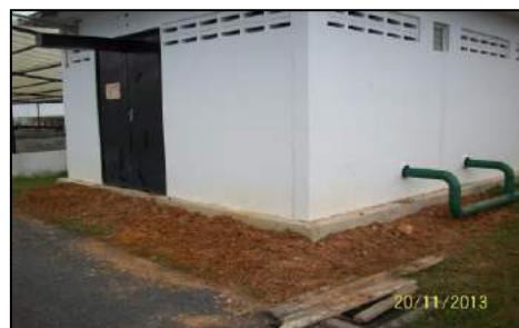
Sewerage Treatment Plant - Kawasan Mendapan Di Blower House Telah Ditambak Dengan Tanah (Sumber: JKR - 20.12.2013)
