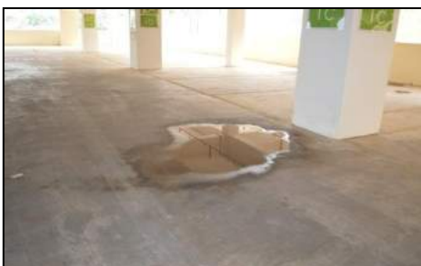
Sub-Besmen 2, Parkir Aras P 2a - Air Bertakung Di Atas Permukaan Lantai (19.06.2013)
