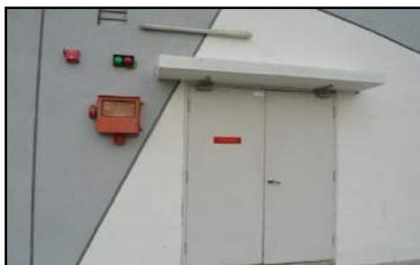
Bilik MSB (Blok Pentadbiran) / Bilik Genset (sub station)
