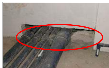
Tingkat 4, Bilik Tangki Air Domestik - Lubang Pada Dinding Belum Ditutup Sepenuhnya (19.06.2013)
