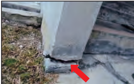
SMS Banting, Banting, Selangor - Keretakan Pada Tiang Surau Di Bahagian Laluan Masuk Untuk Pelajar Perempuan (24.06.2013)
