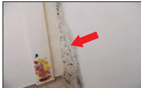
SMAP Bentong, Bentong, Pahang - Resapan Air Di Dinding Bilik Kaunseling Akibat Kebocoran (03.07.2013)
