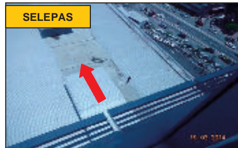
Blok Podium, Aras 5 - Keretakan Pada Permukaan Bumbung Konkrit Rata Telah Diperbaiki (Sumber : JKR - 19.03.2014)
