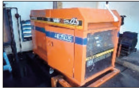
SPK Segama, Lahad Datu, Sabah - Generator Yang Dibekalkan Pada Tahun 2008 Kerap Mengalami Kerosakan (20.08.2013)
