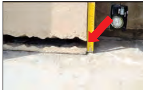
SMAP Bentong, Bentong, Pahang - Renggang Seluas 5cm Pada Tiang Bangunan Rumah Pengetua (Banglo Kelas C) Akibat Mendapan Tanah (03.07.2013)
