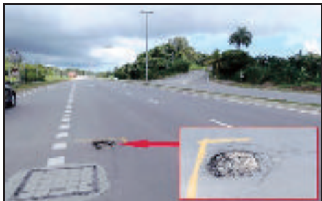
Chainage 2150 - Jalan Berlubang Berbahaya Kepada Pengguna Jalan Raya Terutama Penunggang Motosikal (28.11.2013)
