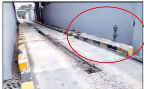
Laluan Eksport, Kompleks CIQ Bangunan Sultan Iskandar, Johor Bahru - Kerosakan Pada Bahagian Mesin Pengimbas (29.08.2013)
