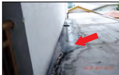
SMS Batu Pahat, Batu Pahat, Johor - Saluran Longkang Kecil Tidak Dibuat Di Tingkat Satu Asrama Perempuan Menyebabkan Air Hujan Bertakung Dan Lantai Berlumut (28.08.2013)
