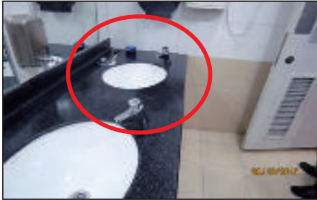
Tandas, Bangunan Pentadbiran - Kedudukan Pili Air Yang Tidak Sesuai (29.10.2013)
