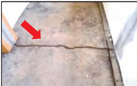
SMAP Bentong, Bentong, Pahang - Keretakan Pada Lantai Bangunan Asrama Lelaki Yang Bersebelahan Dengan Rumah Warden (03.07.2013)
