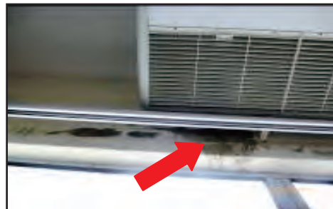
SMS Batu Pahat, Batu Pahat, Johor - Resapan Air Di Dinding Atas Blok Pusat Sumber Akibat Kebocoran (28.08.2013)
