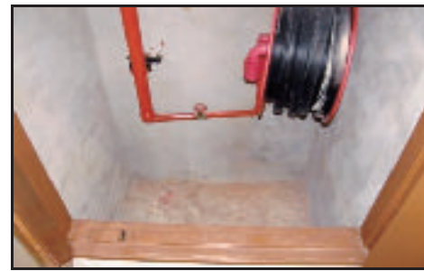
Bilik Hose Reel - Floor Trap Tidak Disediakan. Ini Akan Menyebabkan Air Bertakung Apabila Berlaku Kebocoran Pada Paip (29.10.2013)
