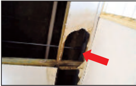
SMAP Betong, Bentong, Pahang - Keadaan Siling Di Tandas Asrama Lelaki Yang Mengalami Kebocoran Dan Resapan Air (03.07.2013)
