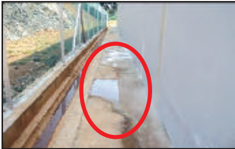
Serian Regional Water Supply - Phase 1 - Air Sentiasa Mengalir Di Parit Dan Sekeliling Tangki Akibat Kebocoran Tangki (24.07.2013)
