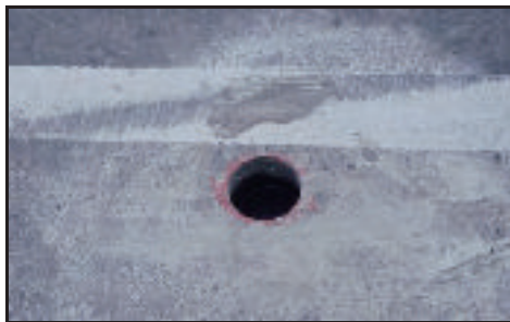
Chainage 250 - Coring Atas Jalan Tidak Ditutup Semula (28.11.2013)
