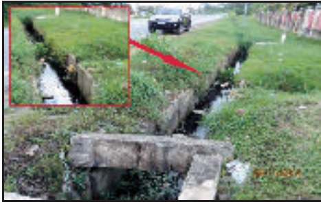
Chainage 600 - Sampah Sarap Bertakung Dalam Longkang (28.11.2013)
