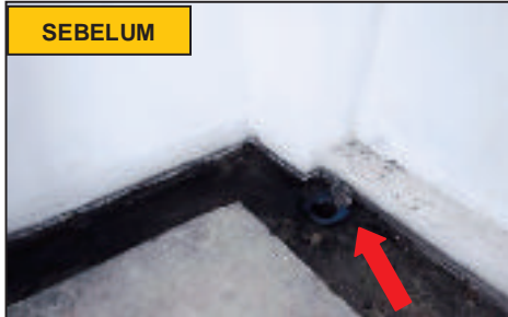
Ruang Servis, Bangunan Pentadbiran - Aras 12 - Air Bertakung Dalam Scupper Drain (30.10.2013)
