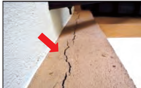
SMAP Bentong, Bentong, Pahang - Keretakan Pada Tiang Bangunan Asrama Lelaki Yang Bersebelahan Dengan Rumah Warden (03.07.2013)
