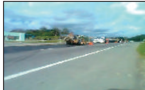
Chainage 0 dan 600 - Tindakan Pembaikan Telah Dilaksanakan Oleh Pihak Kontraktor (Sumber : JKR - 29.04.2014)
