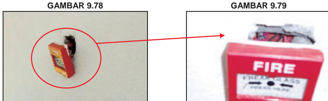
SMS Batu Pahat, Batu Pahat, Johor - Sebahagian Sistem Pengesan Dan Pencegah Kebakaran Yang Rosak Dan Tidak Berfungsi (28.08.2013)
