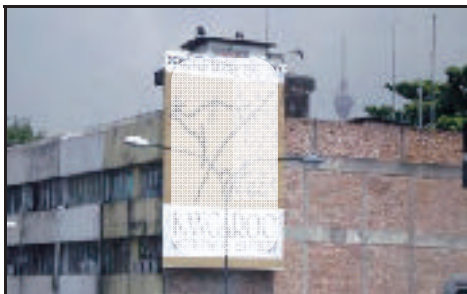
Berdekatan Jalan Loke Yew- - Iklan Dinding Dipasang Secara Haram (24.09.2013)
