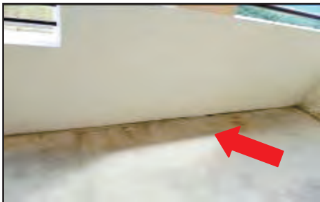
SMAP Bentong, Bentong, Pahang - Saluran Longkang Kecil Tidak Dibuat Di Tingkat Satu Kuarters Kelas G Menyebabkan Air Hujan Bertakung Dan Lantai Berlumut (03.07.2013)
