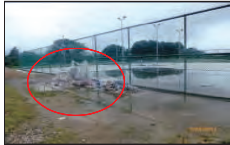
SMAP Bentong, Bentong, Pahang - Kerja Pembaikan Gelanggang Tenis Tidak Selesai Dan Bahan Binaan Masih Berada Di Gelanggang (03.07.2013)
