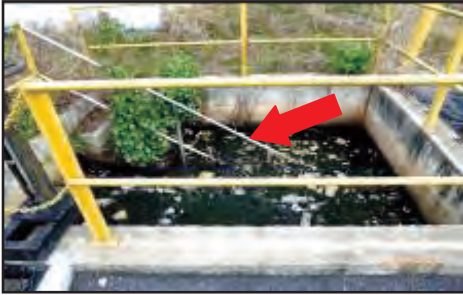
SMS Bentong, Bentong, Pahang - Laluan Tangga Untuk Penyenggaraan Loji Rawatan Kumbahan Telah Tersumbat Dipenuhi Najis Akibat Pam Yang Tidak Berfungsi (03.07.2013)
