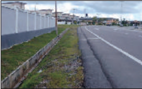
Chainage 700 - Turapan Jalan Yang Tidak Sempurna (28.11.2013)
