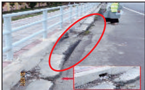
Chainage 1000 - Laluan Inlet Dan Bahu Jalan Tidak Dibina Dengan Sempurna (28.11.2013)
