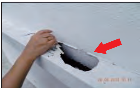
SMS Batu Pahat, Batu Pahat, Johor - Coping Yang Dipasang Pada Luar Tingkap Bangunan Asrama Perempuan Telah Pecah Dan Berlubang (28.08.2013)
