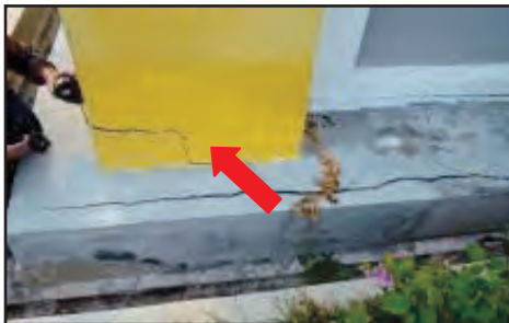
SMS Banting, Banting, Selangor - Keretakan Pada Tiang Bangunan Pusat Sumber (24.06.2013)
