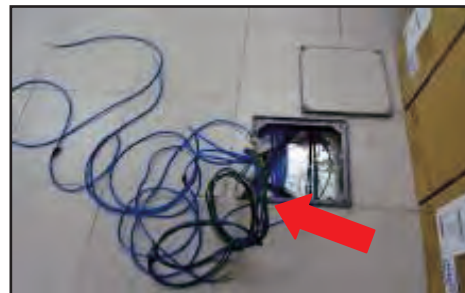
SMS Banting, Banting, Selangor - Kerja Pendawaian Belum Selesai Dan Wayar Tidak Disambung Kepada Soket Di Dalam Makmal Komputer 1 (24.06.2013)
