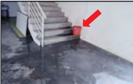
SMS Banting, Banting, Selangor - Air Menitis Daripada Siling Sehingga Membasahi Lantai Di Laluan Tangga Pusat Sumber (24.06.2013)
