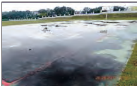
SMS Batu Pahat, Batu Pahat, Johor - Lantai Gelanggang Bola Keranjang Yang Berlumut Akibat Air Bertakung (28.08.2013)
