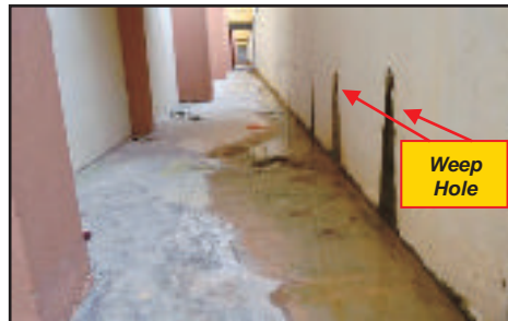
SMAP Bentong, Bentong, Pahang - Air Yang Bercampur Tanah Mengalir Dari Weep Hole Dan Mengotorkan Ruang Lantai Di Hadapan Stor Sukan Astaka Dan Bilik Persalinan Lelaki Dan Perempuan (03.07.2013)
