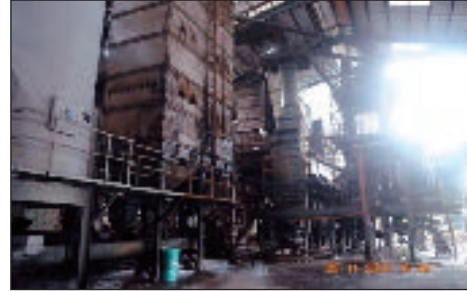
Kilang Sawit Nasaruddin, Perak - Keadaan Kilang Yang Berkarat (20.11.2013)
