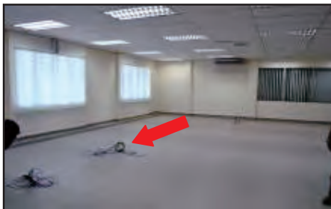
SMS Banting, Banting, Selangor - Keadaan Di Dalam Makmal Komputer 1 Di Mana Kerja Pendawaian Masih Belum Diselesaikan Oleh Kontraktor (24.06.2013)
