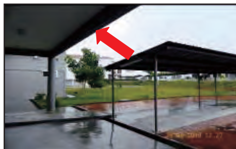
SMS Batu Pahat, Batu Pahat, Johor - Bumbung Di Laluan Pejalan Kaki Tidak Bersambung Ke Bangunan Surau Lebih Kurang 1 Meter Jaraknya (28.08.2013)
