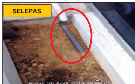
Balai Polis, Bersebelahan Ramp - Saluran Paip Hujan Telah Dipasang Terus Ke Longkang Perimeter Bangunan (30.04.2014)
