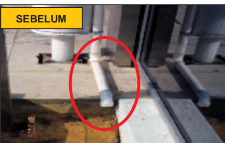
Balai Polis, Bersebelahan Ramp - Saluran Paip Hujan Tidak Dipasang Terus Ke Longkang Perimeter Bangunan (30.10.2013)
