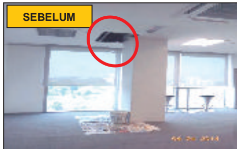
Bilik Ketua Polis Daerah, Bangunan Pentadbiran, Aras 11 - Kebocoran Berlaku Daripada Permukaan Siling (19.03.2014)
