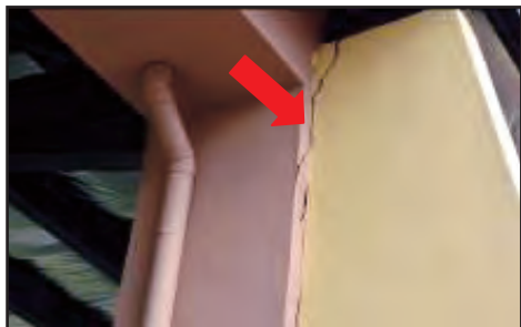
SMAP Bentong, Bentong, Pahang - Keretakan Pada Tiang Astaka (Pandangan Sebelah Kiri) (03.07.2013)
