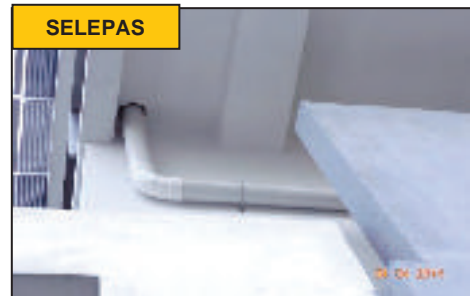
Bangunan Pentadbiran, Aras 1 - Paip Salur Keluar Telah Disambung Terus Ke Longkang (Sumber : JKR - 04.04.2014)
