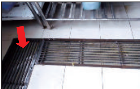
SMS Batu Pahat, Batu Pahat, Johor - M.S Grating Untuk Internal Scupper Drain Yang Berkarat Dan Rosak (28.08.2013)
