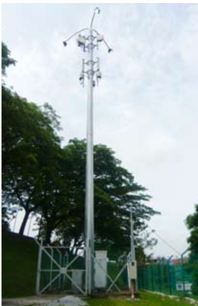
Antara tapak telekomunikasi yang didirikan untuk perkhidmatan tanpa wayar seperti 3G dan LTE
